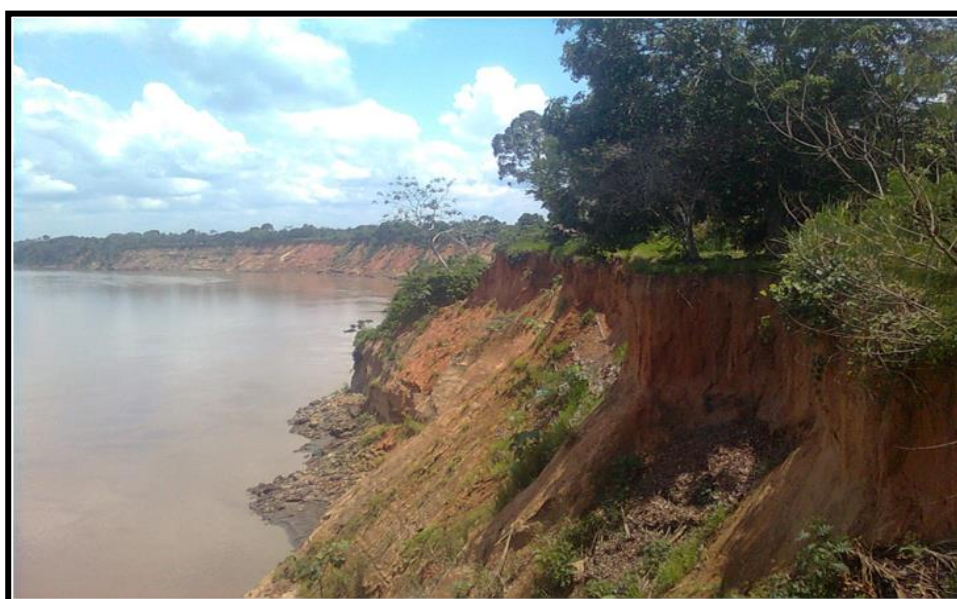
Foto N° 8 Vista desde la parte alta del talud en la zona de La Pastora, donde se aprecian derrumbes al pie de los acantilados y la deforestación alrededor del meandro La Pastora.
