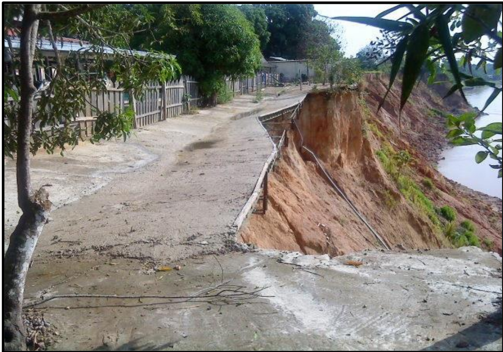
Foto N° 3 Problemática representativa a causa de la erosión lateral efectuada en el margen derecho de la zona de estudio (zona La Pastora).
