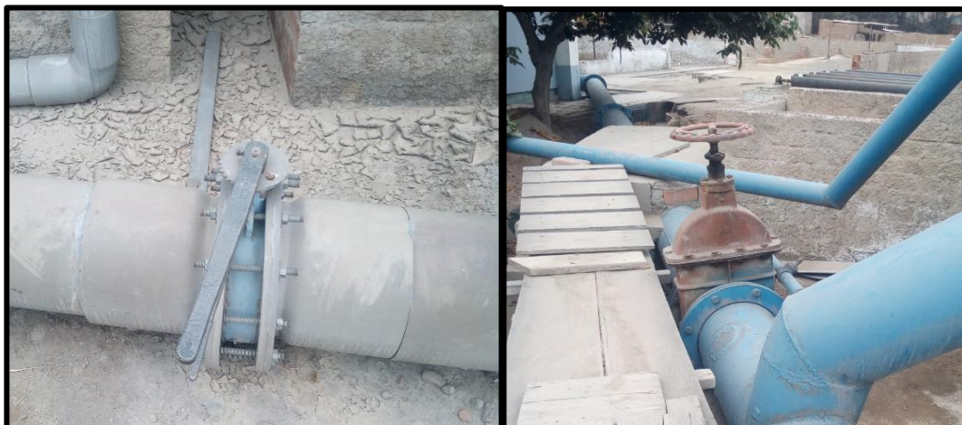
Foto N° 28 Válvula tipo mariposa (Lado izquierdo) y tipo compuerta (Lado derecho) para la regulación del caudal que ingresa al modelo.
