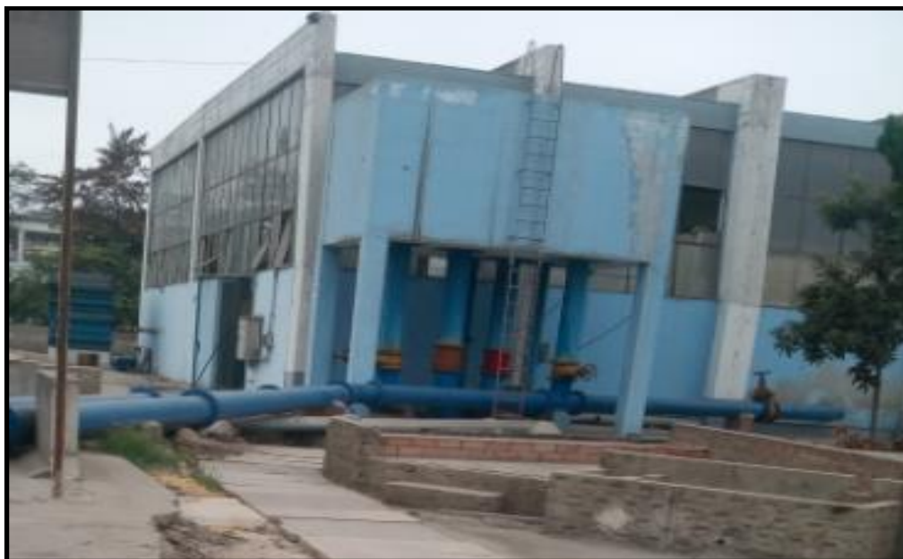
Foto N° 13 Tanque elevado permanente para el almacenamiento de agua junto a las tuberías de impulsión con sus respectivas válvulas.
