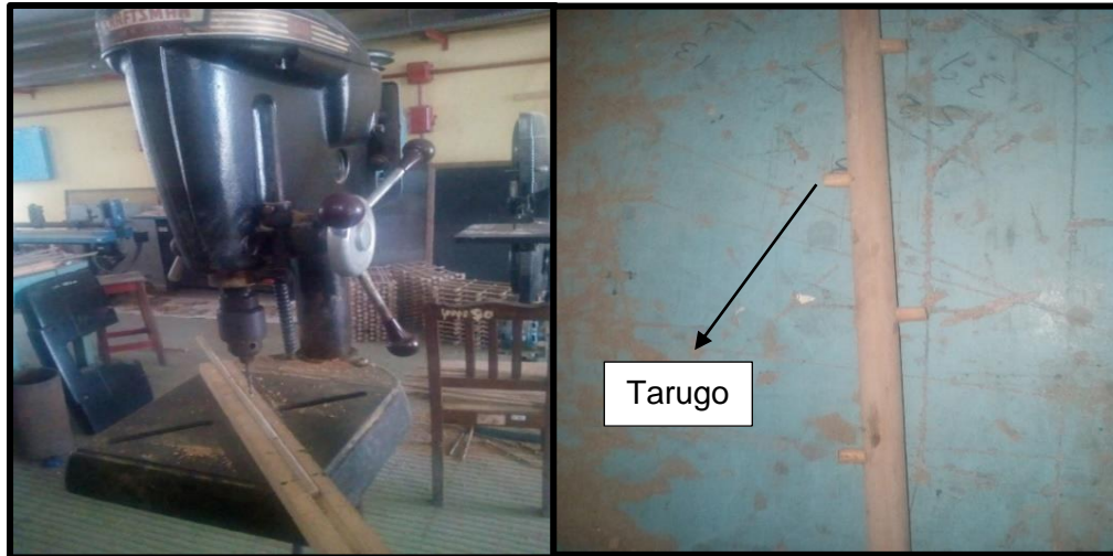
Foto N° 33 Perforación de los troncos para colocar tarugos (lado izquierdo) y un tronco con tarugos colocados para la fijación.
