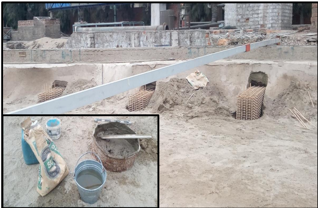
Foto N° 39 Uso de pilotes de madera y mortero para empotrar el espigón sobre el lecho del río.
