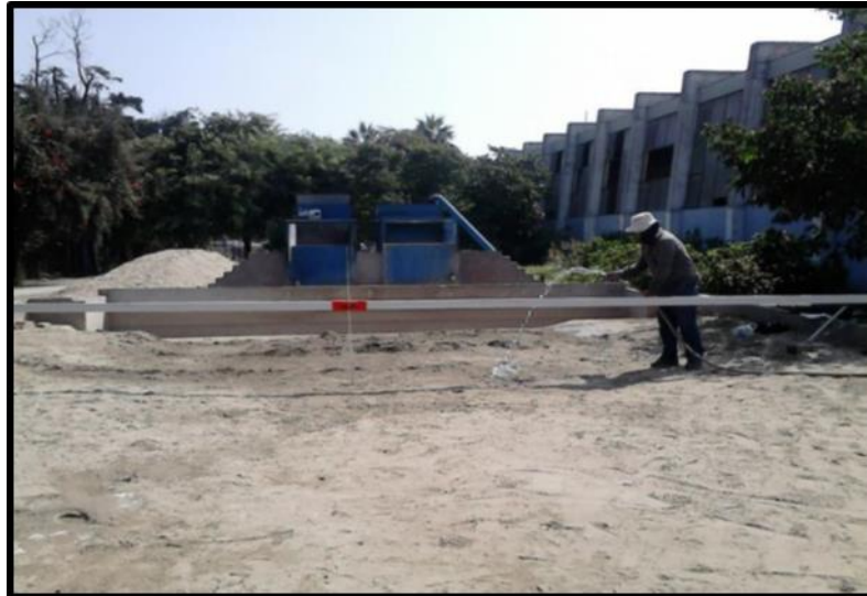
Foto N° 20 Regla que se coloca en cada sección transversal para la colocación de tarugos.
