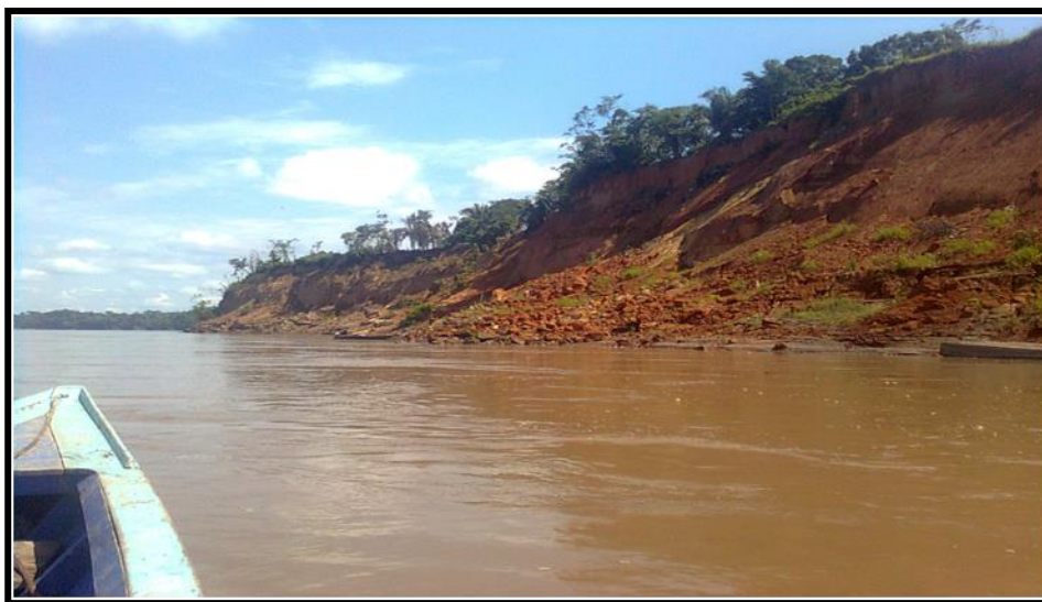
Foto N° 7 Vista del talud en la zona de La Pastora, donde se aprecian derrumbes de material no consolidado y paredes verticales en la parte alta.
