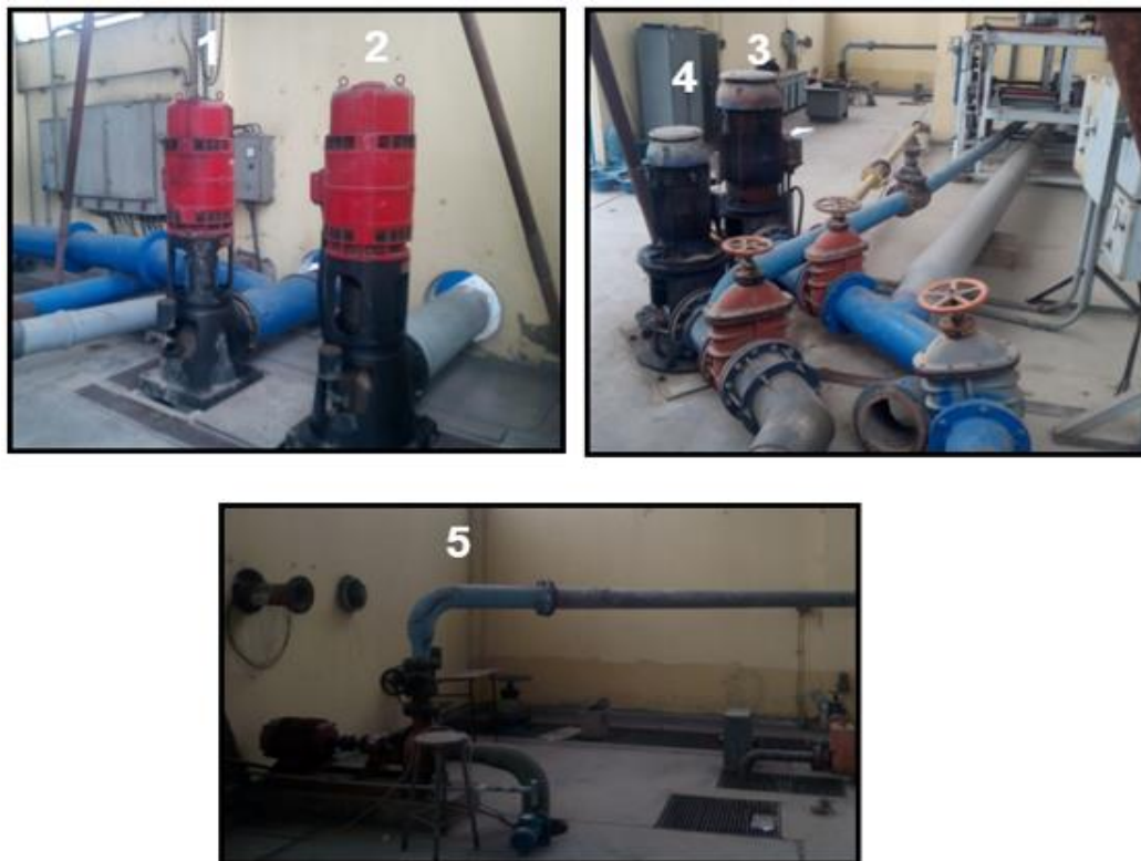
Foto N° 14 Ubicación de las 4 electrobombas y bomba centrífuga en el área de didáctica para el abastecimiento del modelo físico.
