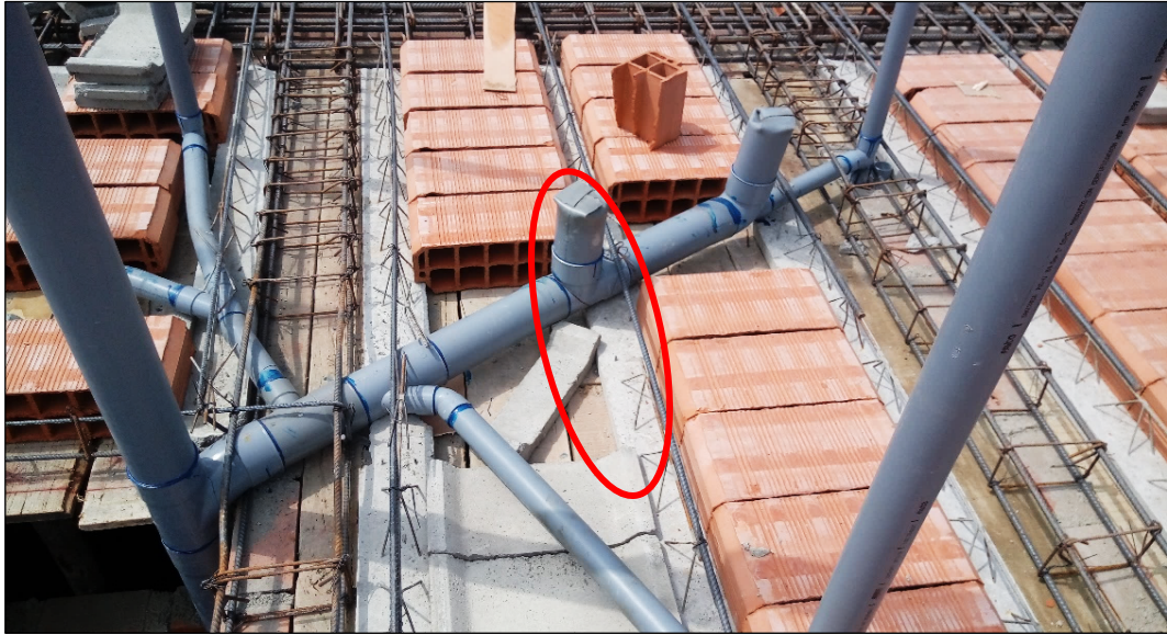
Figura N°4.15 Detalle de las Instalaciones Sanitarias, que Pasan por los Alambrones en Zigzag de la Vigueta Alitec.
