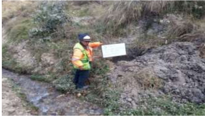
Figura N° 16.- Afloramiento de agua donde no se contempló estructuras de Subdrenaje Fuente: Elaboración Propia
