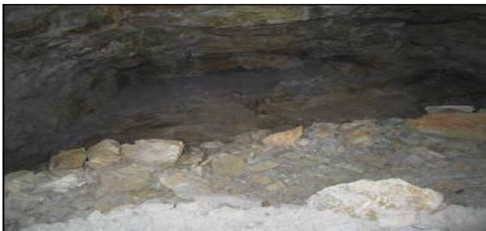
Figura 07: Frente Fracturas del Túnel Victoria
