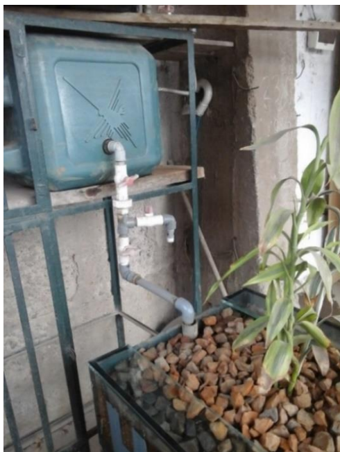
Fig. 10: tanque regulador de presión de ingreso, tubería con válvulas de regulación, incluye derivación con válvula de purga para muestreo y calibración del caudal.
