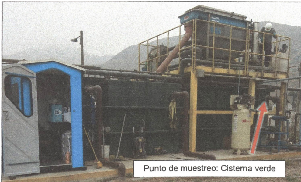
Figura 6 Punto de muestreo: Ingreso a la Planta de Tratamiento de Aguas Residuales - Industria Alimentaria
