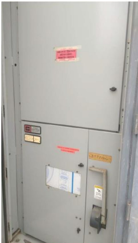
Figura 7. Barra 4,16 kV TG2, Fuente: Central Térmica
