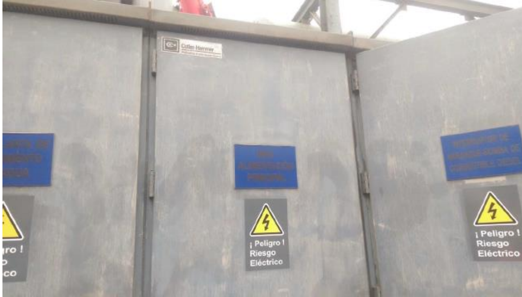
Figura 6. Barra 4,16 kV TG1, Fuente: Central Térmica
