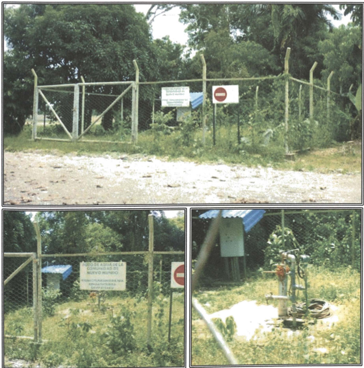
Foto 1. POZO PERFORADO EXISTENTE DE LA EMPRESA REPSOL.
