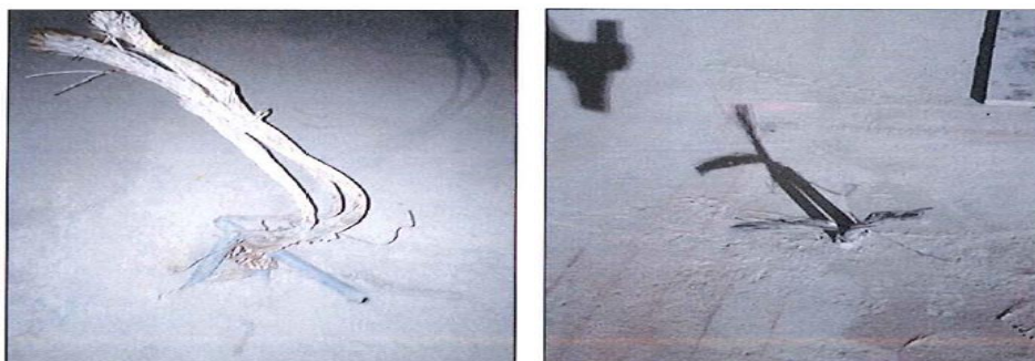
Fig.N°4.12 Observaciones que sustentan el reporte de no conformidad
