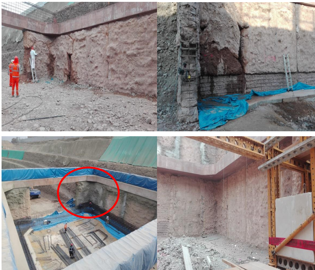
Fig. N°4.3 Acero expuesto en muros pantalla empotrados para la construcción del pozo de ataque en la zona del patio Taller.
