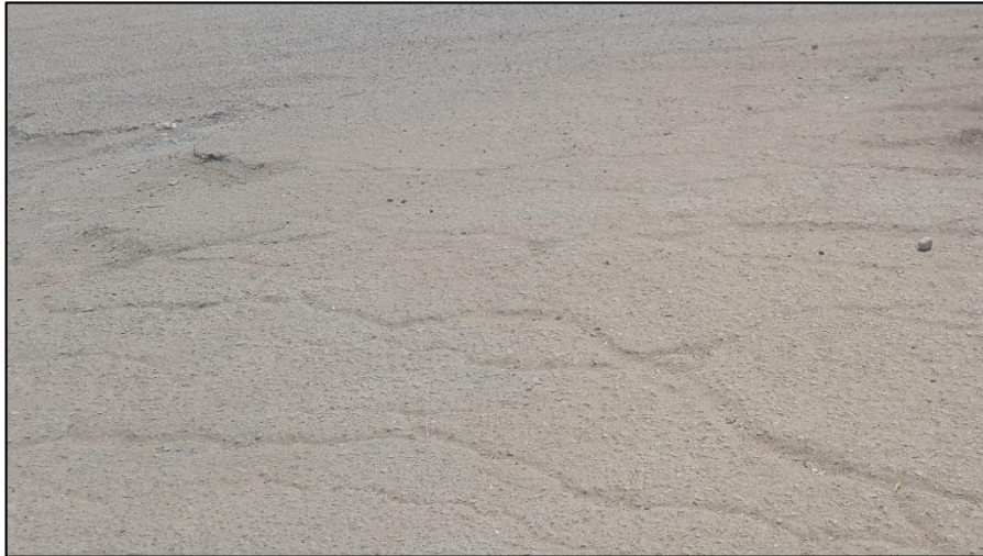
Figura N°23 Av. Víctor Raúl Haya de la Torre con Severidad Moderada. Fuente: Elaboración Propia.
