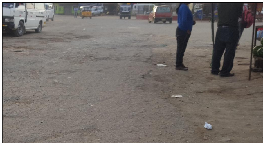
Figura N°17 Carretera Cañete Yauyos con Severidad Alta. Fuente: Elaboración Propia.
