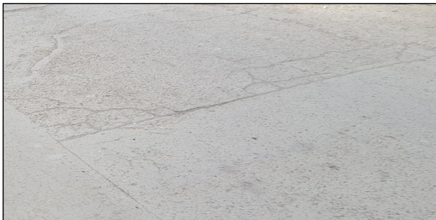
Figura N°13 Jr. 28 de Julio con Severidad Alta. Fuente: Elaboración Propia.
