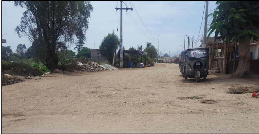
Figura N°28 Av. los Eucaliptos presenta Sección transversal impropia con Severidad Moderada. Fuente: Elaboración Propia.
