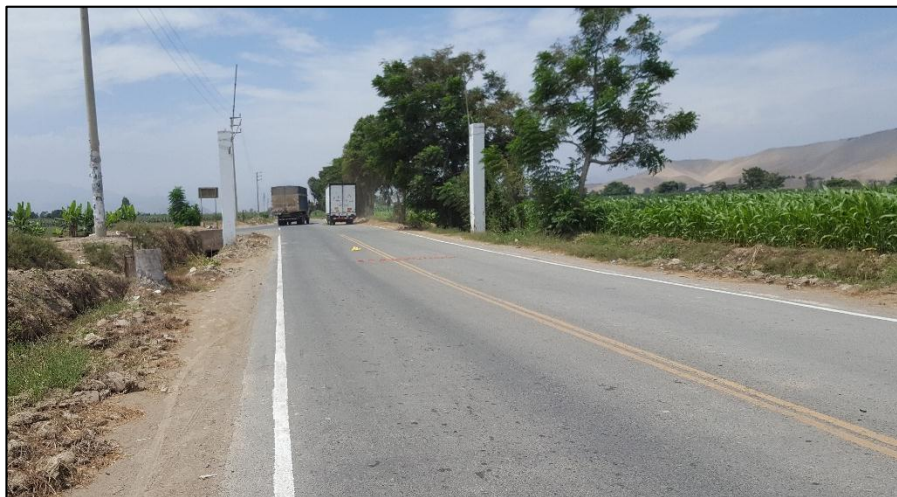
Figura N°12 Carretera a San Benito con Severidad Baja. Fuente: Elaboración Propia.
