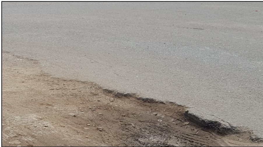
Figura N°16 Av. Ramos con Severidad Alta. Fuente: Elaboración Propia.
