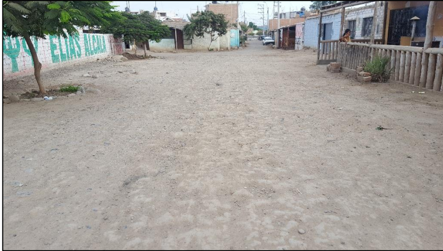
Figura N°26 Calle las Acacias presenta Baches con Severidad Baja. Fuente: Elaboración Propia.
