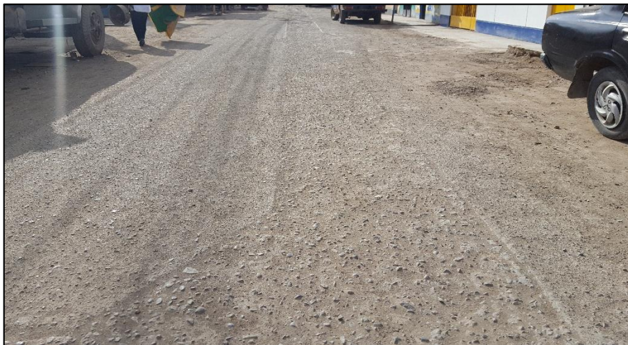
Figura N°25 Jr. Sucre con Severidad Alta. Fuente: Elaboración Propia.
