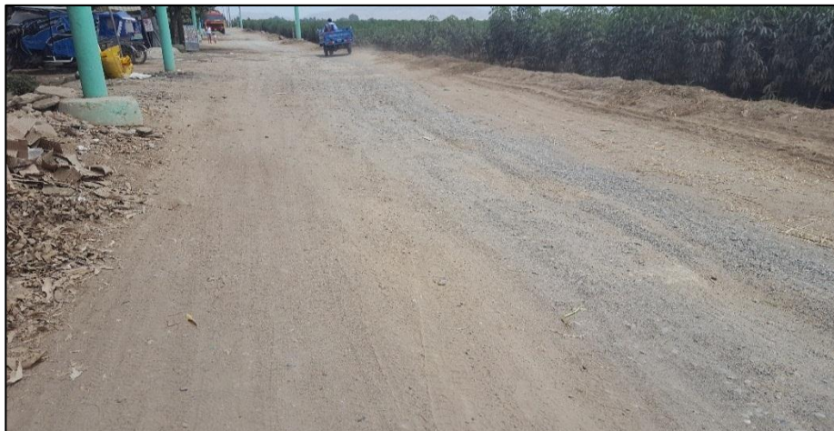
Figura N°31 Acceso a Canta Gallo presenta Ahuellamientos con Severidad Moderados. Fuente: Elaboración Propia.
