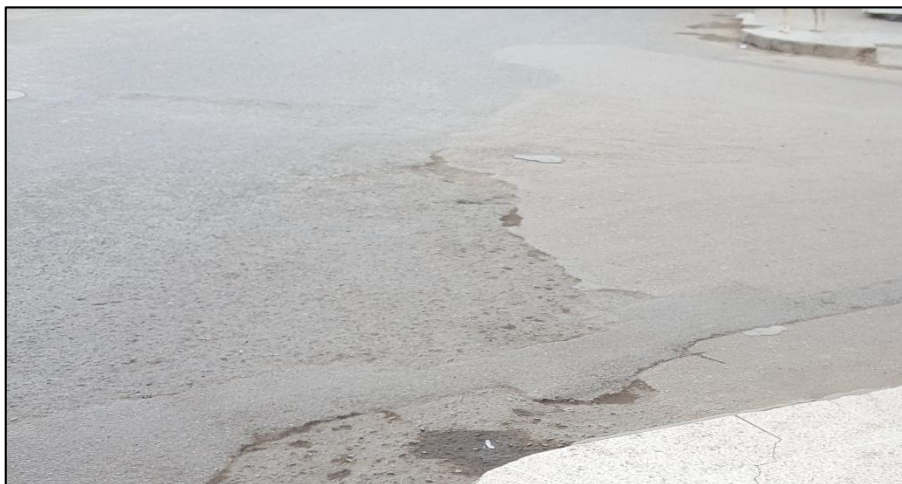
Figura N°24 Av. La Mar con Severidad Baja. Fuente: Elaboración Propia.
