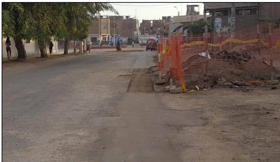
Figura N°19 Av. Benigno Ríos con Severidad Baja. Fuente: Elaboración Propia.
