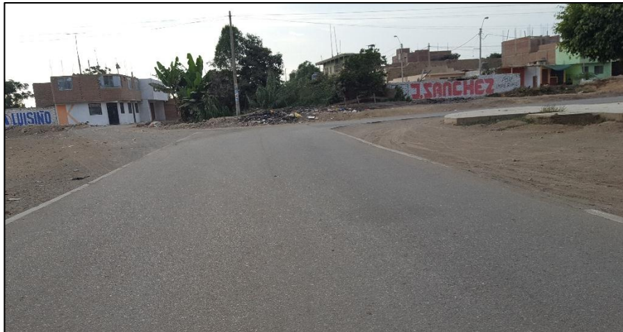
Figura N°20 Calle Las Palmeras con Severidad Moderada. Fuente: Elaboración Propia.
