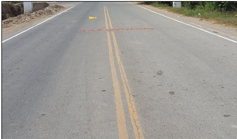
Figura N°18 Carretera a San Benito con Severidad Moderada. Fuente: Elaboración Propia.
