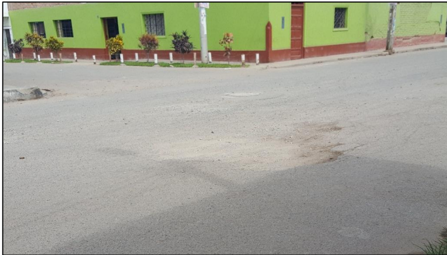
Figura N°15 Jr. Augusto B Leguía con Severidad Moderada. Fuente: Elaboración Propia.
