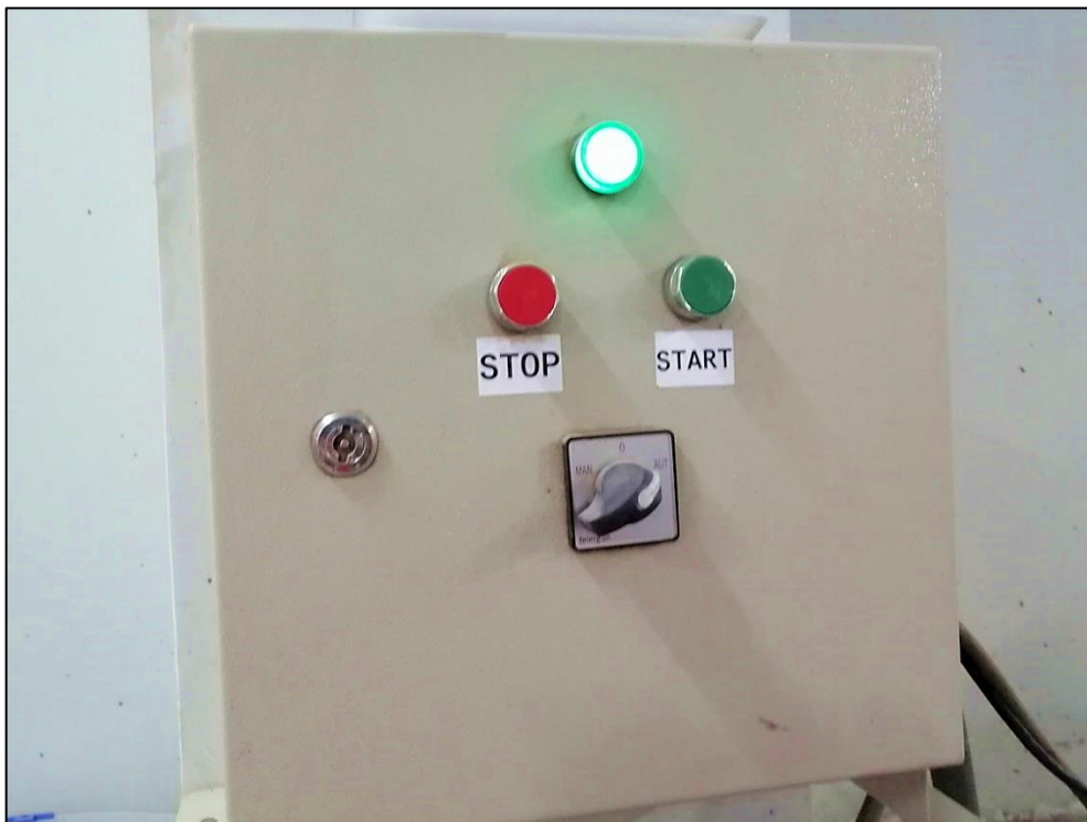
Figura 13 Tablero eléctrico trifásico
