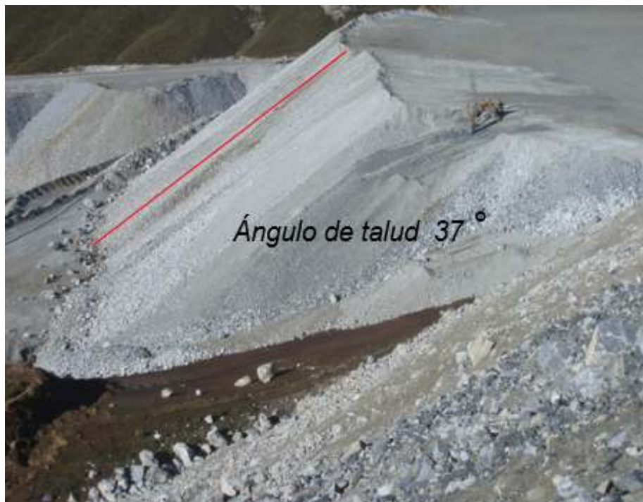
Figura 6.6 Muestra la formación de los ángulos de taludes y taludes combados
