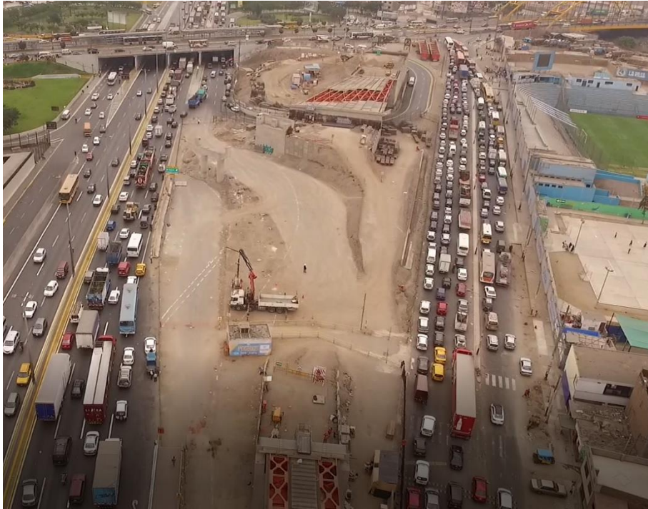
Figura 6.3. Vista aérea del viaducto 4.2 antes de iniciar con la optimización en el frente. Fuente: Elaboración Propia
