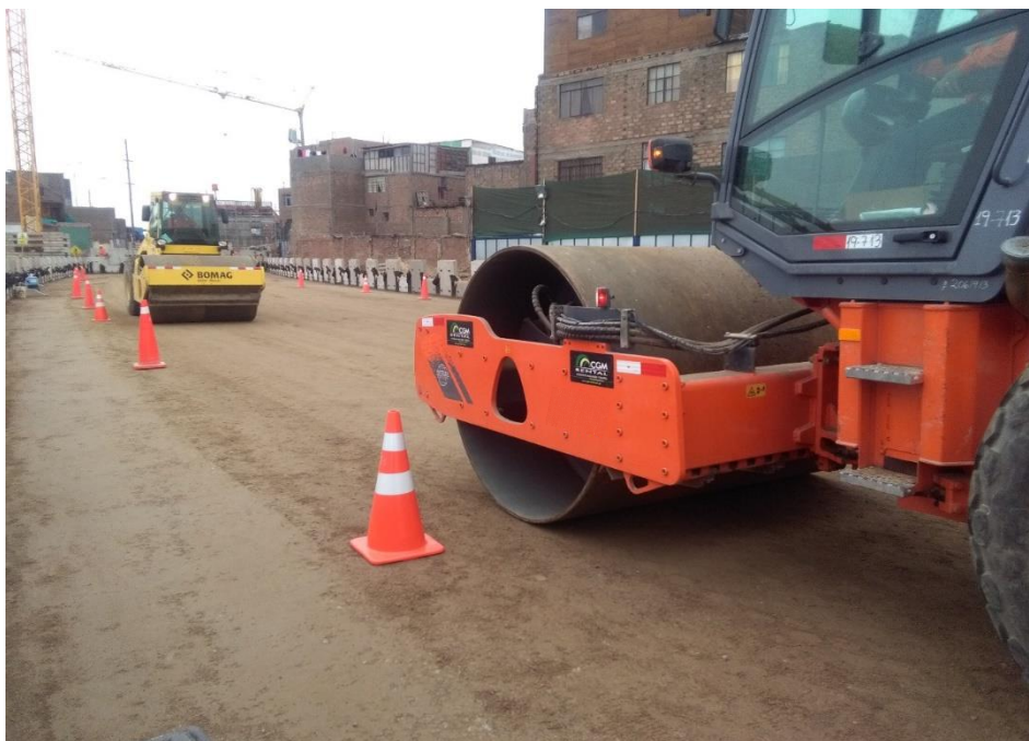
Figura 6.13. Rodillos compactadores HAMM 3410 y BOMAG BW 211 compactando frente a frente en el sector 01 del muro de tierra armada del viaducto 6.1.
