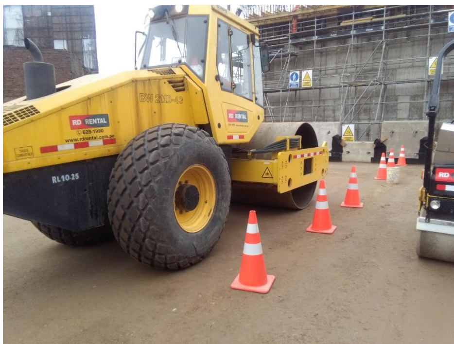
Figura 6.16. Rodillo BOMAG BW 211 compactando en el sector 02 del muro de tierra armada del viaducto 6.1.
