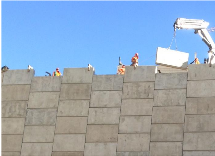
Figura N° 36: Colocación de paneles de concreto durante la construcción de un muro de suelo reforzado.
