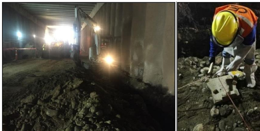
Figura N°5.26 Excavación y Colocación de cable Puesta a Tierra Lateral en el Túnel 0+680 – Elaboración Propia
