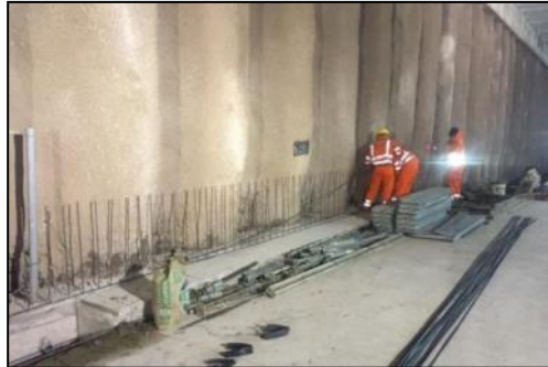
Figura N°5.40 Acero de Muretes de Concreto Armado – Elaboración Propia
