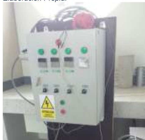
Imagen N° 21. Tablero de Control Eléctrico. Elaboración Propia.
