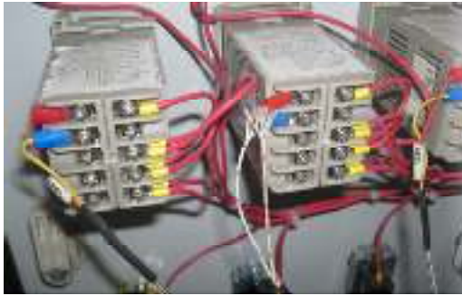
Imagen N° 19. Pirómetros y Cableado de la Termocupla. Elaboración Propia.
