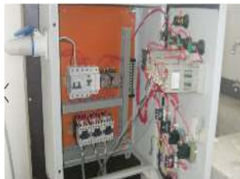
Imagen N° 22. Vista interna del Tablero Eléctrico. Elaboración Propia.
