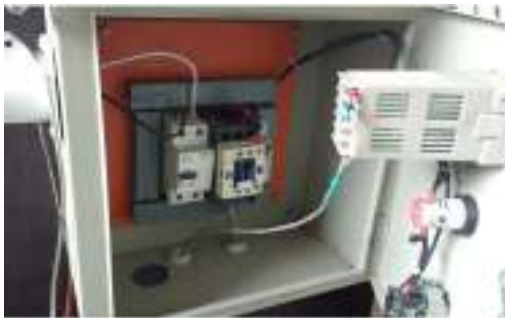
Imagen N° 1. Vista interna de la caja de control. Elaboración Propia.
