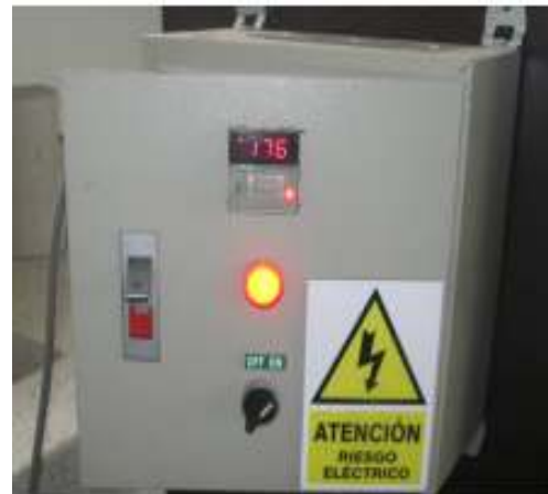
Imagen N° 3. Vista del tablero eléctrico en funcionamiento. Elaboración Propia.
