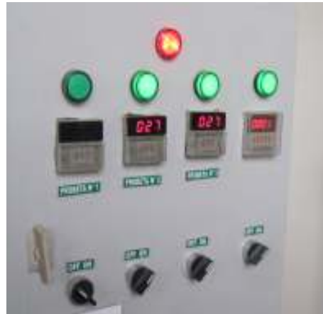
Imagen N° 23. Tablero Eléctrico en funcionamiento. Elaboración Propia.
