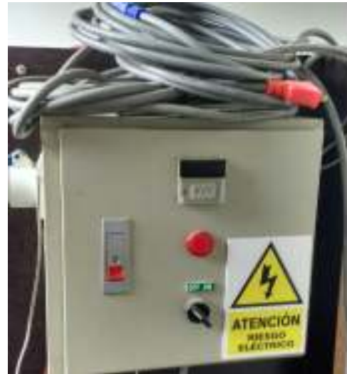
Imagen N° 2. Tablero Eléctrico Simple. Elaboración Propia..
