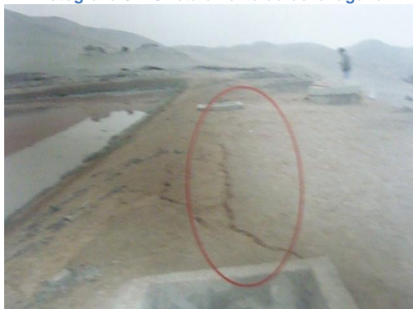
Fotografía 54: Grieta en el talud de la laguna
