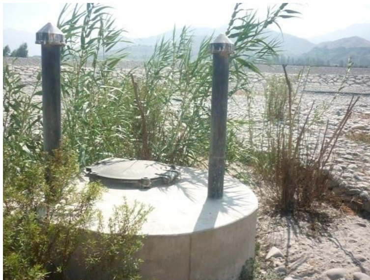
Fotografía 1: Tapa de la cámara de la galería filtrante.
