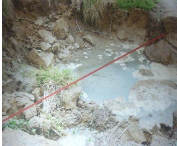
Fotografía 52: Punto donde se rompió la tubería
