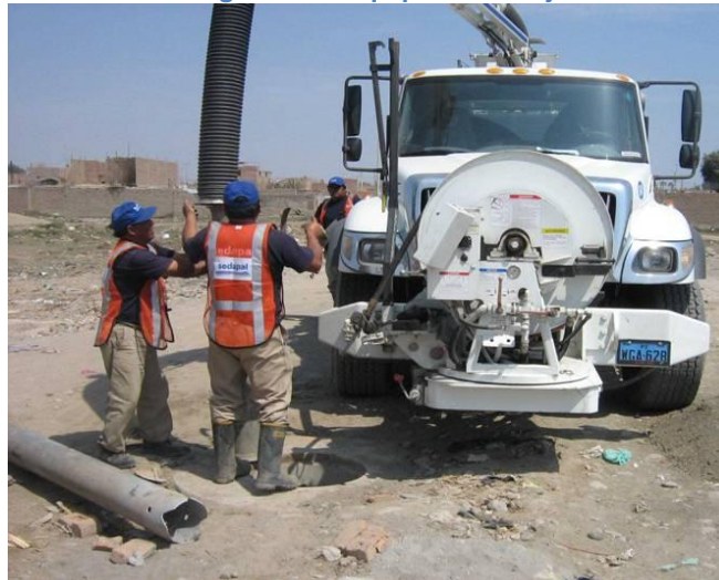
Fotografía 38: Equipo de hidrojet
