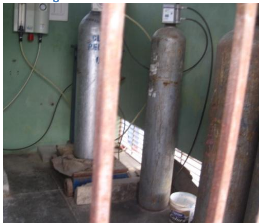
Fotografía 26: Sistema de clorinación
