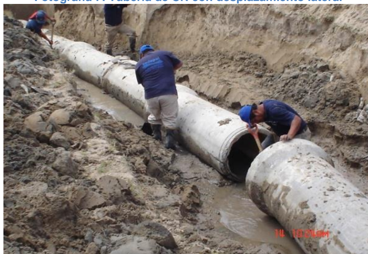
Fotografía 7: Tubería de CR con desplazamiento lateral
