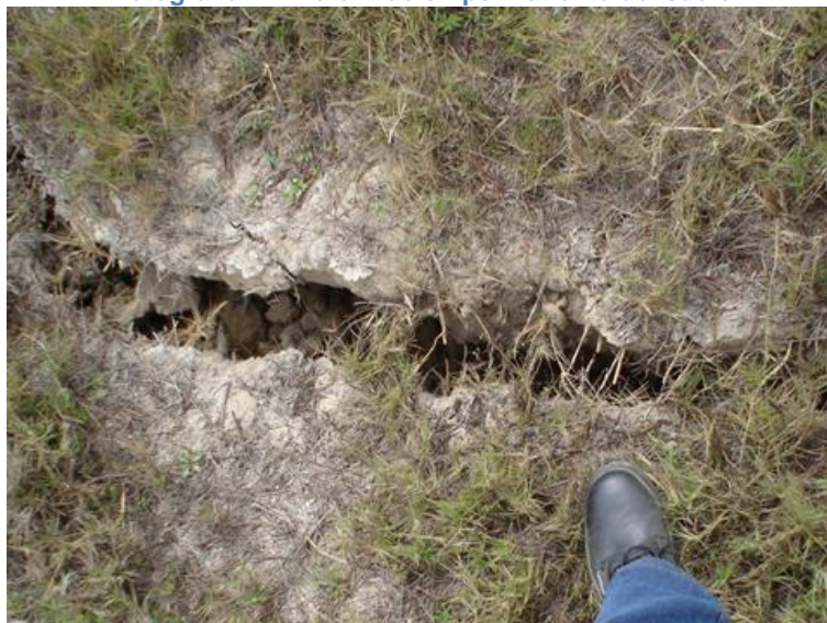
Fotografía 11: Deformación permanente del suelo
