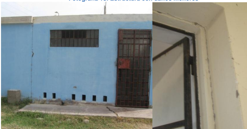
Fotografía 18: Estructura con daños menores
