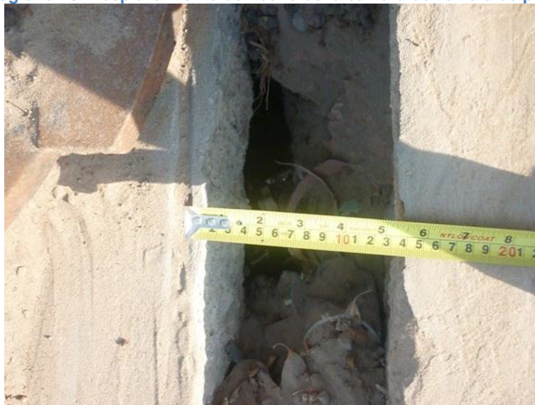
Fotografía 16: Desplazamiento del techo de la cámara de válvula de purga.
