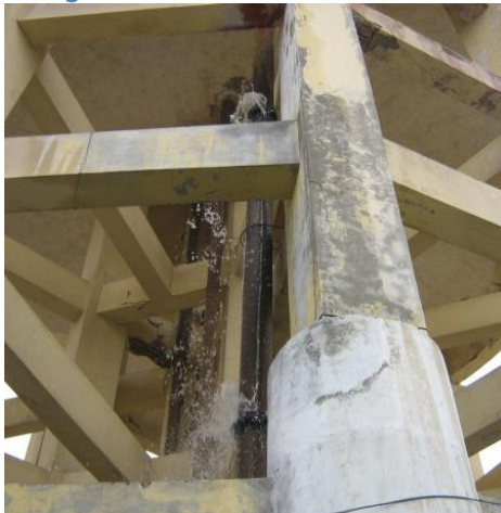
Fotografía 23: Rotura de Tubería de F°F°
