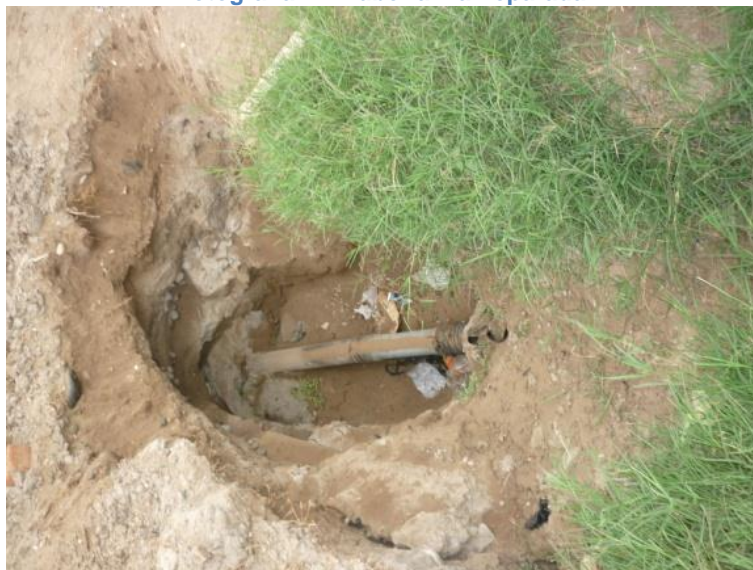
Fotografía 42: Tubería mal reparada.
