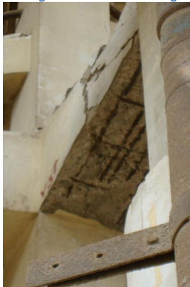
Fotografía 24: Daño en la viga
