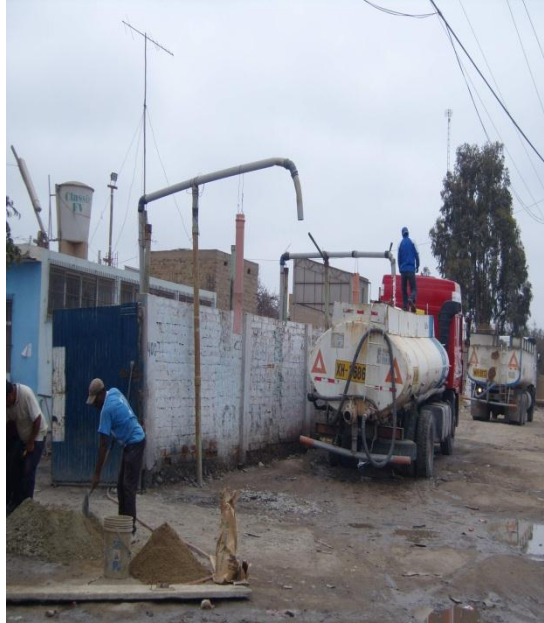
Fotografía 66: Surtidor improvisado en RE-01
