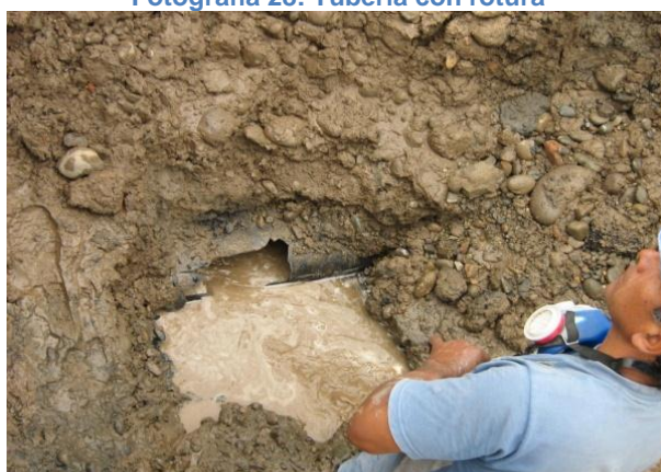
Fotografía 28: Tubería con rotura
