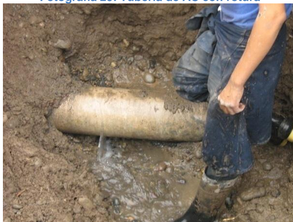
Fotografía 29: Tubería de AC con rotura
