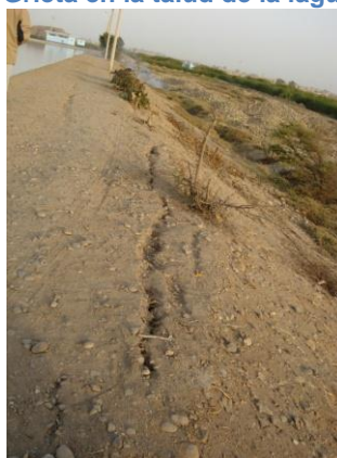
Fotografía 51: Grieta en la talud de la laguna Boca de Río
