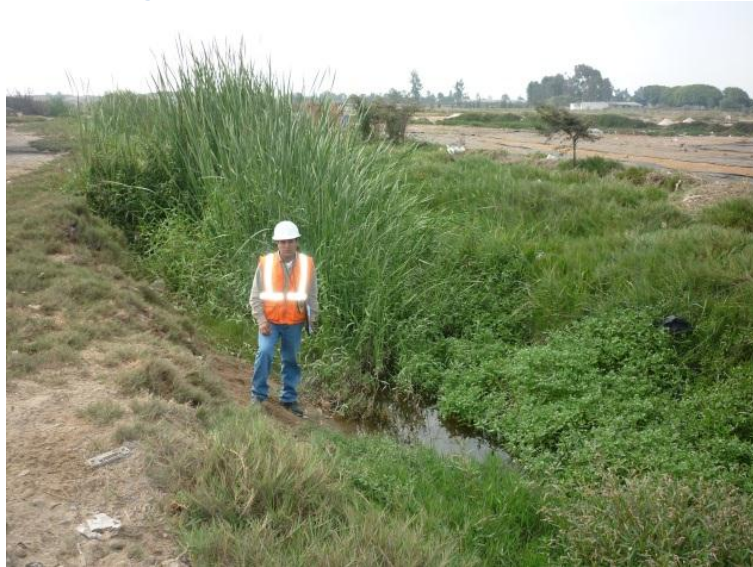
Fotografía 34: Ubicación dónde falló tubería de PVC
