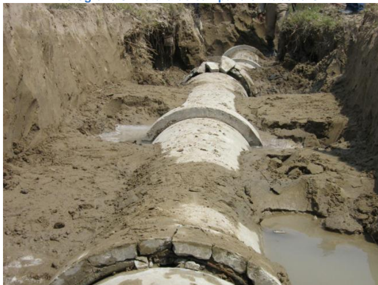
Fotografía 9: Rotura de campana en tubería CR
