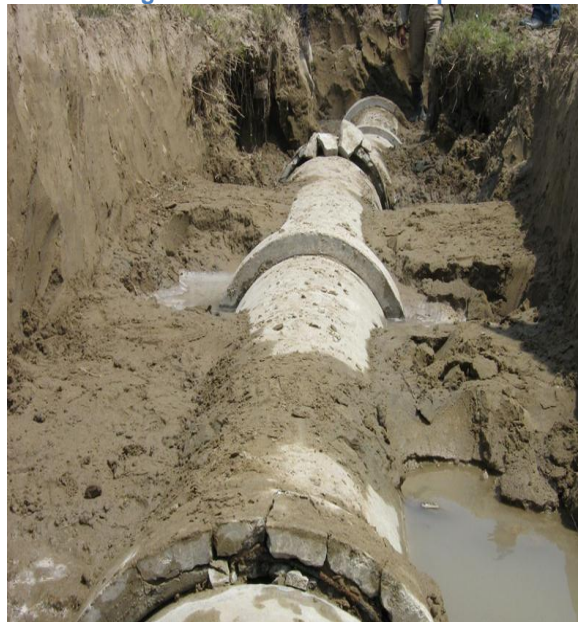
Fotografía 67: Tubería CR colapsado
