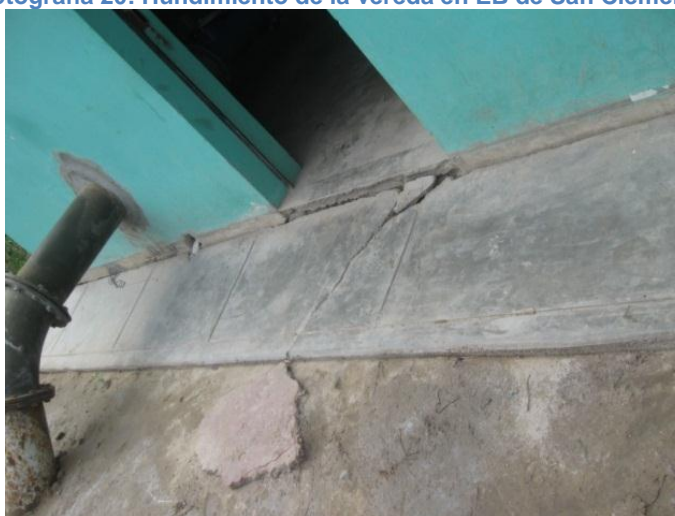
Fotografía 20: Hundimiento de la vereda en EB de San Clemente.
