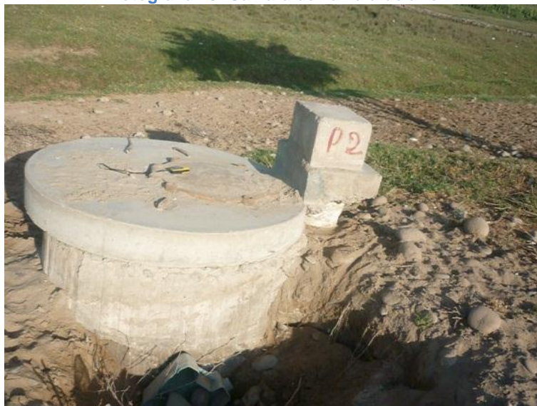
Fotografía 15: Cámara de válvula de aire
