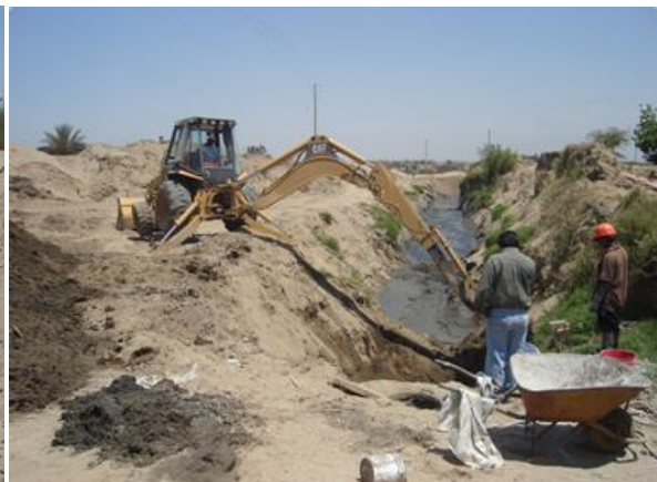
Fotografía 63: Colector principal Av. Siete Villa Valverde
