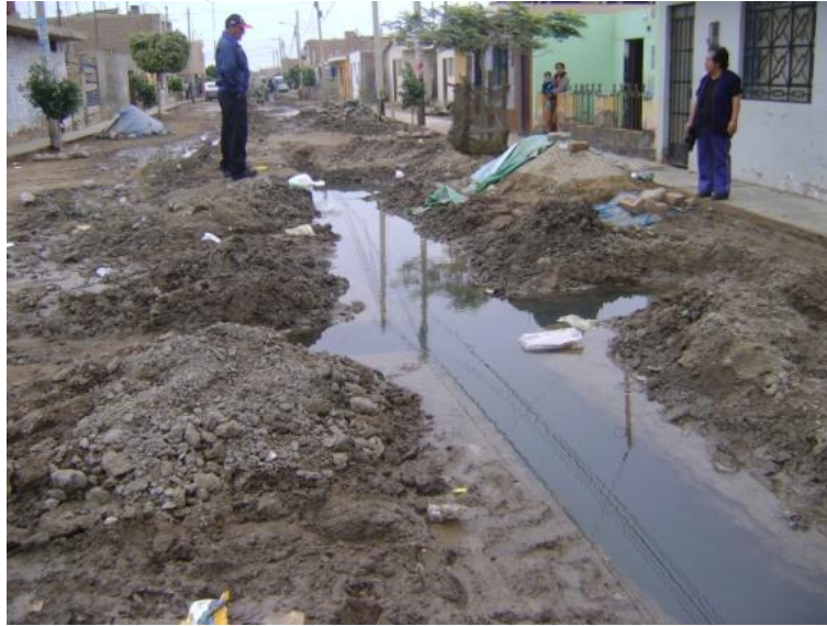
Fotografía 36: Redes colectores colapsados.
