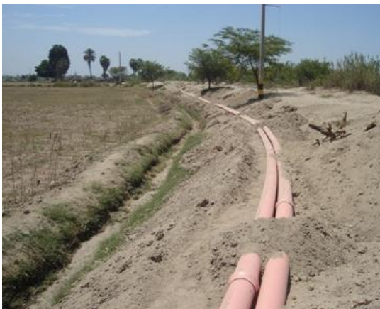
Fotografía 64: Bombeo directo a buzón de colector colapsado
