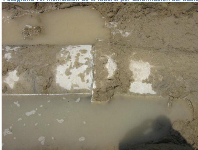
Fotografía 10: Inclinación de la tubería por deformación del suelo
