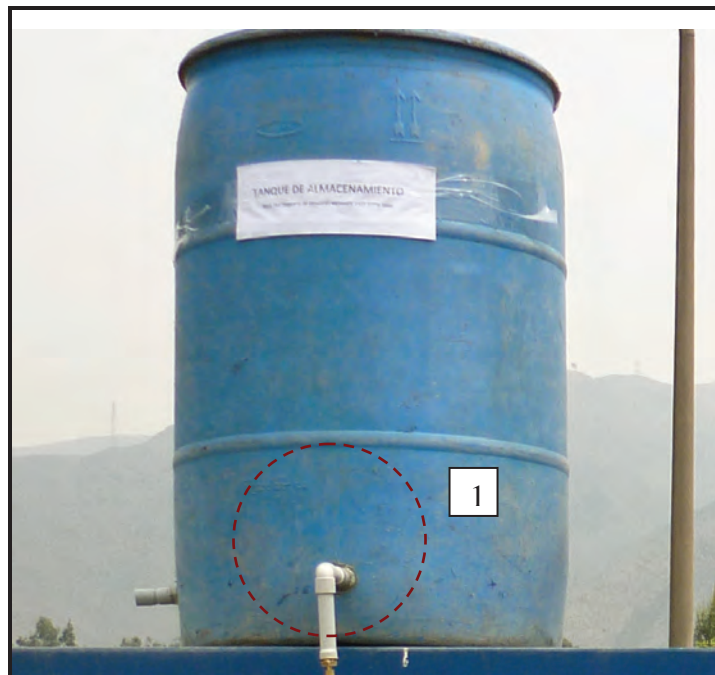
Foto 5. 2: Vista frontal del Tanque de Alimentación. (1)Salida del afluente del reactor.
