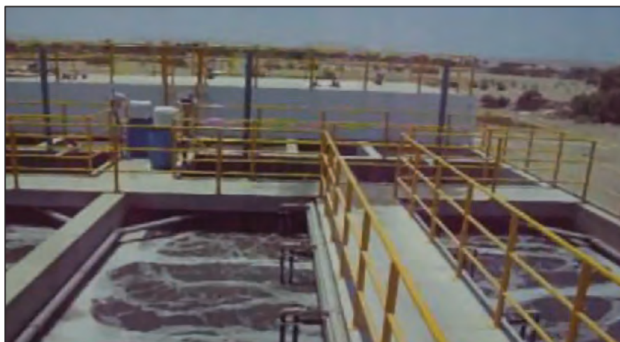
Foto 3. 6: Planta de tratamiento lodos activados para el Hotel Libertador Paracas (Ica, Perú)
