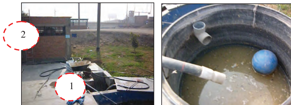
Foto 6. 11: La fotografía de la izquierda muestra la captación de agua residual proveniente del colector Huaycan. El círculo rojo N°1 indica la ubicación de la bomba sumergible y el círculo N°2 indica la ubicación del timer . En la fotografía de la derecha se muestra el desnivel máximo que se consigue con el bombeo del desagüe.
