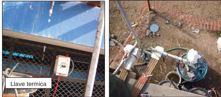
Foto 6. 18: La fotografía de la izquierda muestra la llave térmica ABBC32 con el cual se prende y apaga la bomba de agua. La fotografía de la derecha muestra la ubicación del tanque donde se almacena el afluente de los TSA y la bomba de agua.
