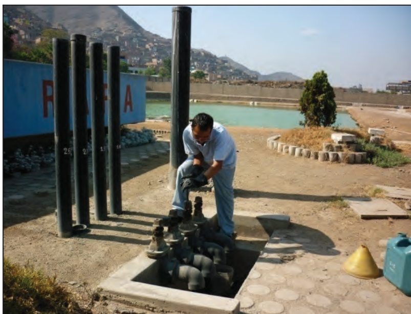
Foto 6. 2: En la fotografía se observa la extracción del lodo proveniente del UASB ubicado en CITRAR-UNI.
