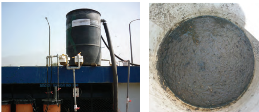
Foto 6. 13: En la fotografía de la izquierda se aprecia la tubería de limpieza y rebose. En la fotografía de la derecha se aprecia el lodo acumulado en el tanque de almacenamiento.
