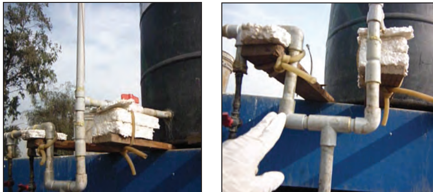
Foto 6. 14: La fotografía de la izquierda muestra el grifo general con el cual se puede cerrar el ingreso de desagüe a los TSA. La fotografía de la derecha se aprecia la trampa de solidos que se construyo para evitar el ingreso de solidos a los TSA.
