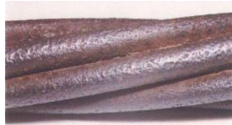
Figura 77: Acero de pretensar del cual se limpió el óxido, se encuentra “picado”.
