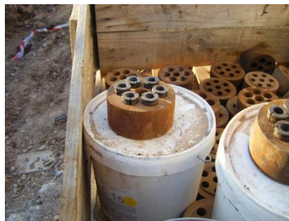
Figura 76: Cabezas de anclaje afectadas por corrosión general.
