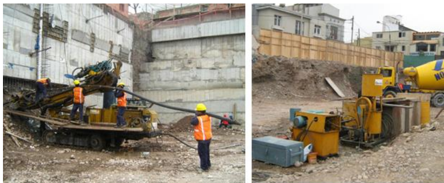
Figura 35: Instalación del tendón de anclaje, y vista de los equipos de inyección de lechada.
