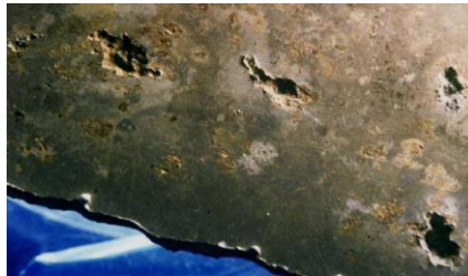
Figura 80: Plancha metálica que sufrió ataque bacteriano.
