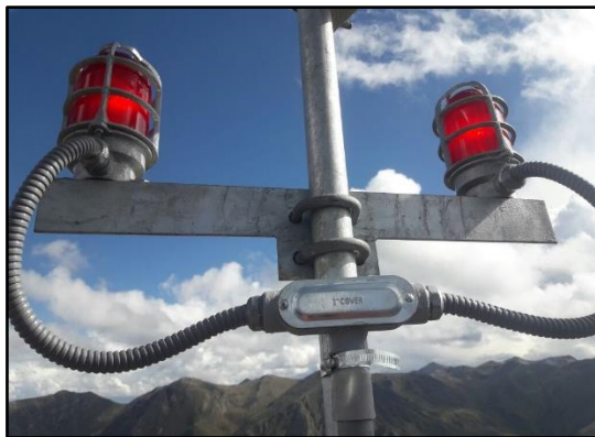
Fig. N° 70: Luz de Balizaje Fuente: Propia
