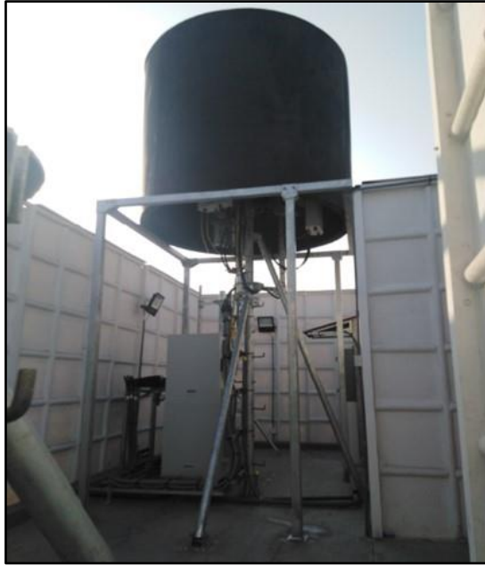
Fig. N° 31: Mimetizado Tipo Tanque de agua- Vista Exterior Fuente: propia
