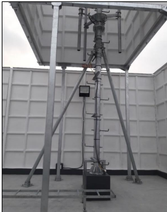
Fig.N°21: Mástil Arriostrado Vista Inferior Fuente: propia
