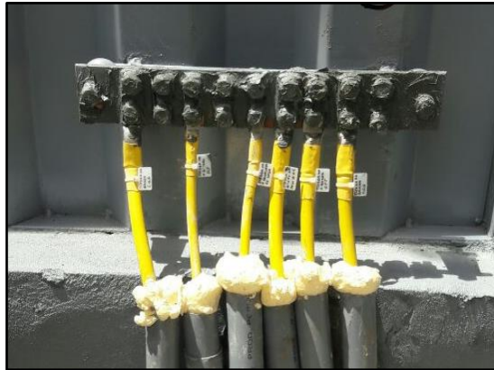
Fig. N° 71: Barra Bornera Fuente: Propia
