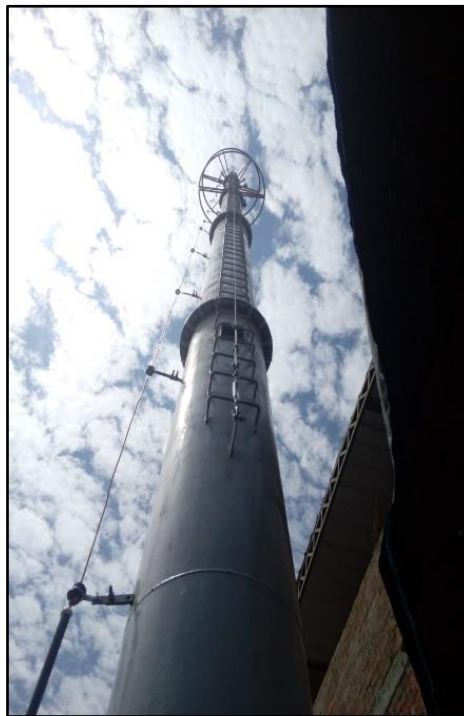
Fig. N° 30: Monopolo Vista Superior Fuente: propia
