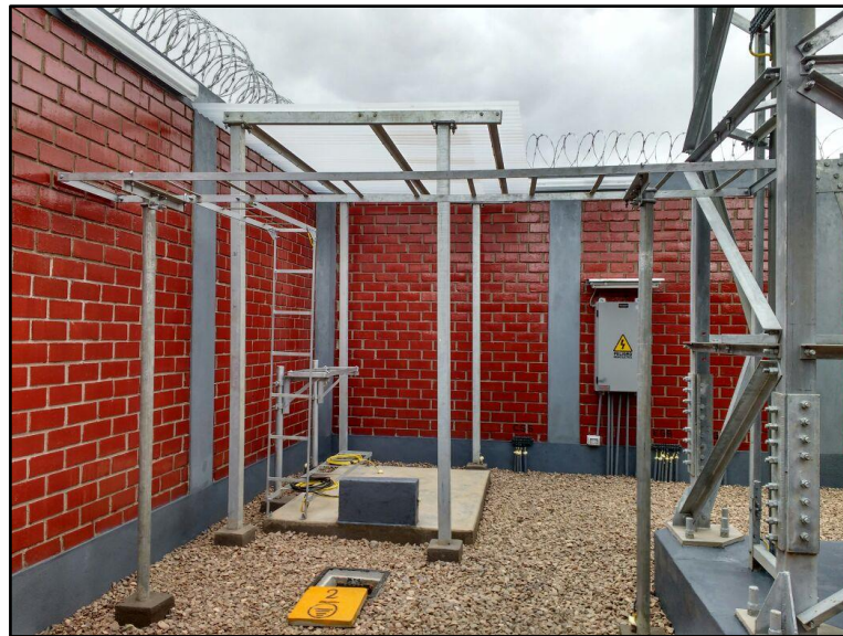
Fig. N° 61: Escalerilla Rack – Soporte de cobertura de equipos Fuente: Propia
