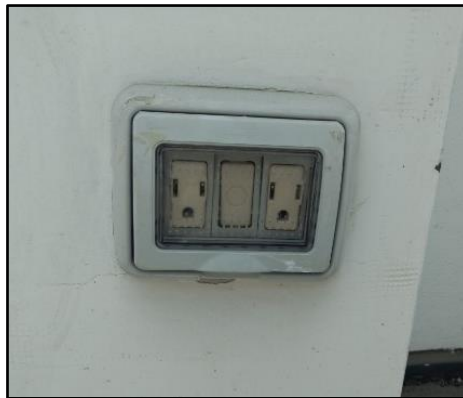
Fig. N° 69: Tomacorriente doble. Fuente: Propia
