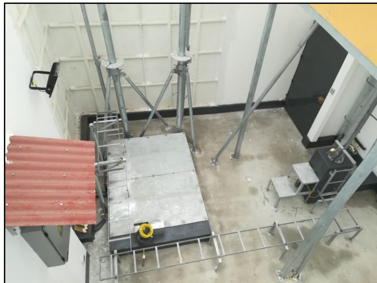
Fig. N°13: Estación Base Celular Tipo Rooftop - Vista Interior Fuente: propia
