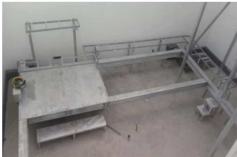
Fig. N° 62: Plataforma Metálica Fuente: Propia
