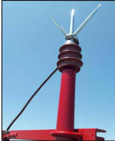
Fig. N° 72: Pararrayos Tipo Franklin. Fuente: Propia
