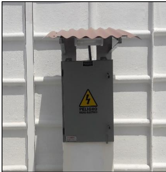
Fig. N° 63: Tablero Eléctrico – Vista Exterior. Fuente: Propia
