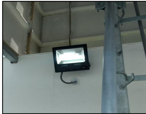
Fig. N° 68: Luminaria Tipo Reflector Fuente: Propia
