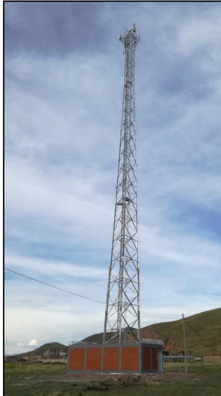
Fig.N°16: Estación Base Celular Tipo Greenfield - Vista Exterior Fuente: Propia
