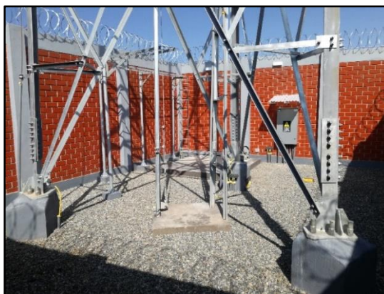
Fig.N°17: Estación Base Celular Tipo Greenfield - Vista Interior Fuente: Propia
