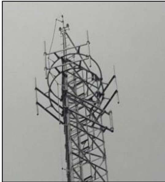
Fig. N° 23: Soporte para antena MW Fuente: propia
