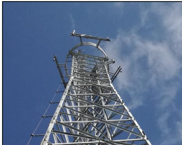
Fig. N° 22: Soporte para Antena RF. Fuente: propia
