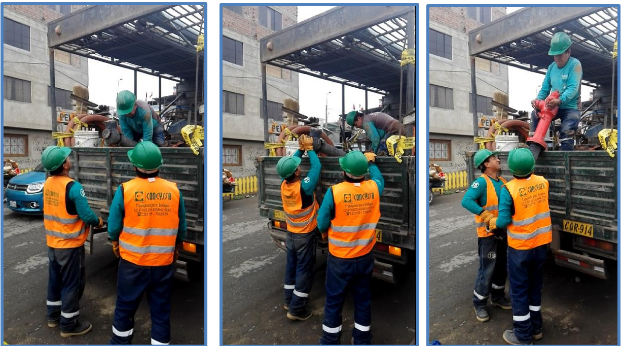
Figura N°31: Descarga del grifo contra incendio
