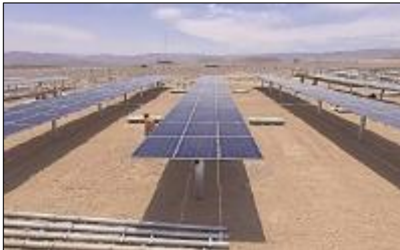
Figura 19: Vista de los paneles solares de la C.S. Intipampa.
