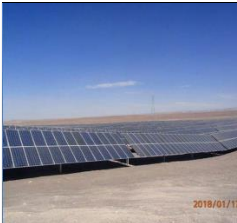
Figura 17: Vista de paneles solares de la C.S. Rubí
