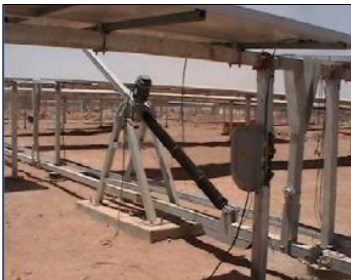
Figura 27: Vista de los paneles solares en C.S. Panamericana Fuente: Ficha técnica de la C.S. Panamericana (Dirección de Supervisión-Osinergmin, 2019)
