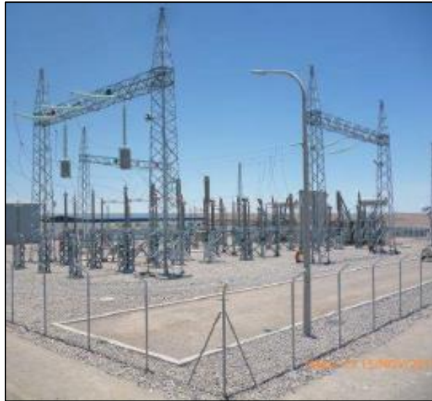
Figura 18: Subestación de la C.S. Rubí
