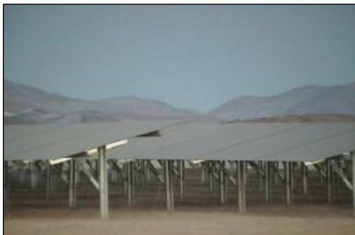
Figura 29: Vista de los paneles solares en C.S. Repartición Fuente: Ficha técnica de la C.S. Repartición (Dirección de Supervisión-Osinergmin, 2019)
