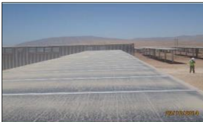
Figura 25: Vista de los paneles solares en C.S. Moquegua FV
