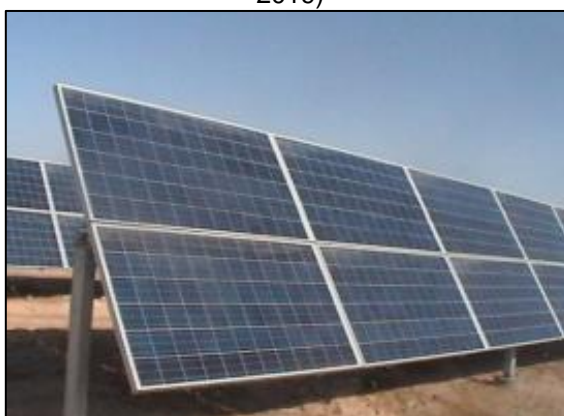
Figura 31: Vista de los paneles solares en C.S. Tacna Solar Fuente: Ficha técnica de la C.S. Tacna Solar (Dirección de Supervisión-Osinergmin, 2019)
