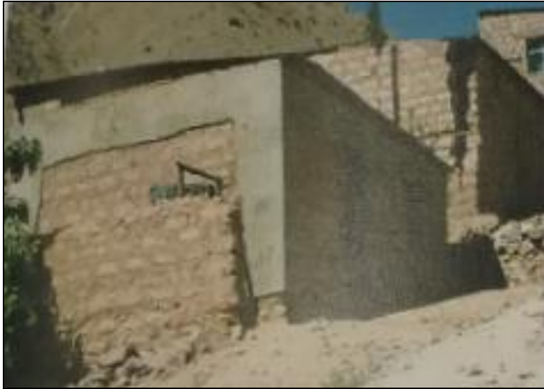
Figura N° 34: Vivienda reforzada de adobe.
