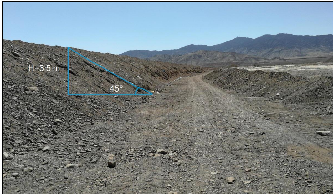
Figura N° 30: Ubicación de trabajo a realizar: Canalización de lecho Fuente: Visita de campo
