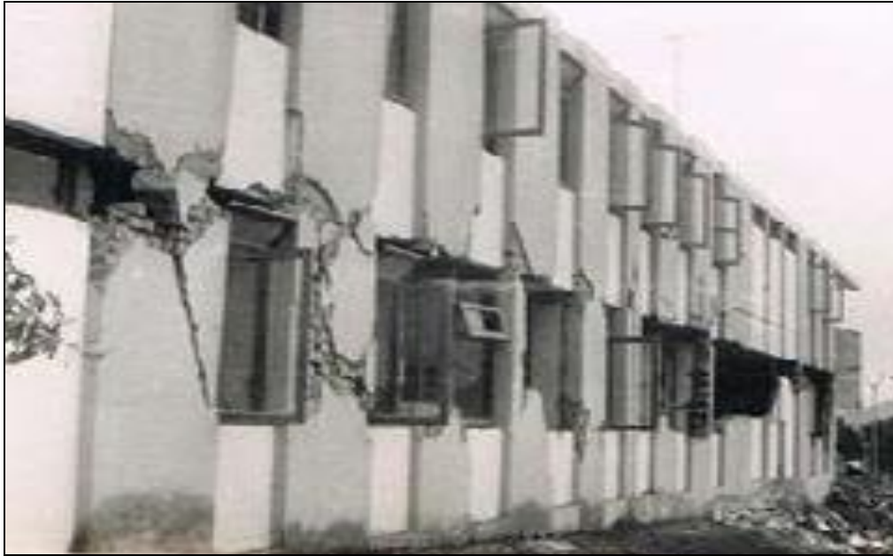
Figura N° 42: Vivienda de albañilería mal confinada, Chimbote 1970.
