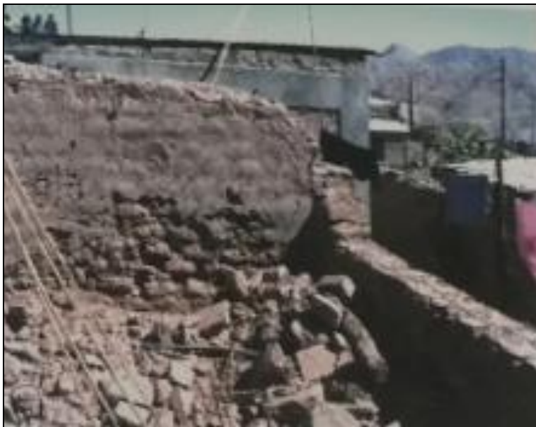
Figura N° 35: Viviendas de adobe sin reforzar.
