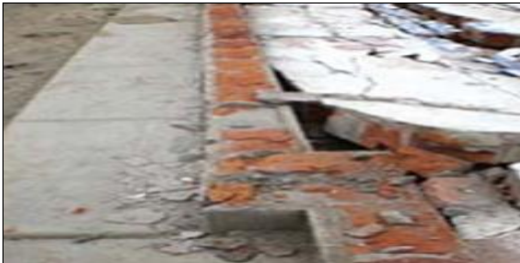
Figura N° 45: Centro educativo de albañilería mal confinada, Chíncha 2007.
