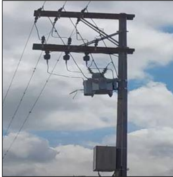
Figura 2.14 Ejemplo de seccionalizador (del alimentador 8va Sur de la S. E. Chimbote Sur)
