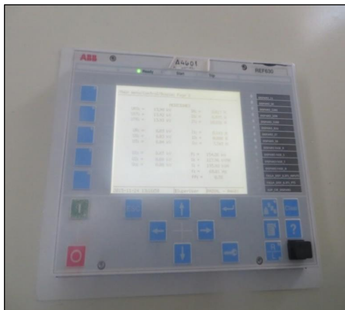
Figura 2.10 Ejemplo de un relé IED de sobrecorriente (marca ABB)
