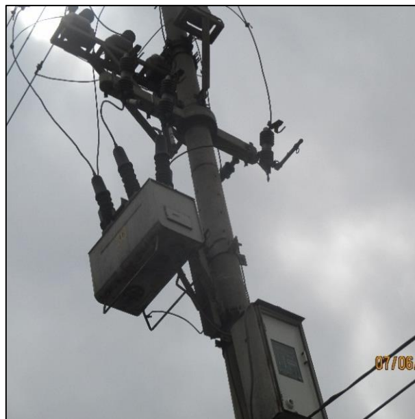
Figura 2.12 Ejemplo de Reconector (Bellamar, Chimbote Sur)
