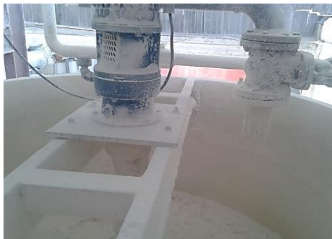
Figura 2.2: Lechada de cal en tanque de agitación
