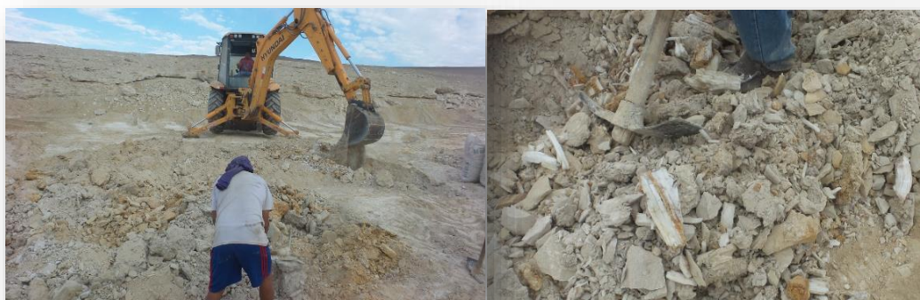
Figura 7.1 La maquinaria ablanda el terreno y el trabajador desmenuza los trozos grandes y separa los materiales no deseados del área removida.
