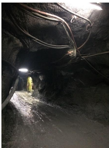
FIGURA 5.6 Tuberías de Agua y Aire en el NV 4240.
