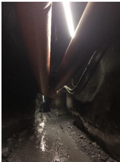
FIGURA 5.8 Tuberías de Agua y Aire, Manga de Ventilación en el NV 4180 de Sección Promedio de 3.5 x 4.0 m 2 .
