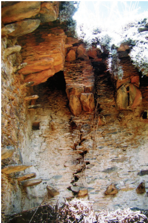
Foto C5.15: Detalle del enlucido de barro y grieta en el interior de la de la chullpa B039, esquina Noreste.
