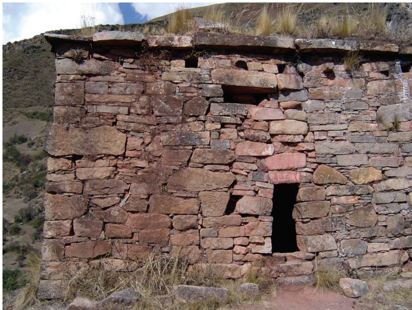
Foto C4.5: Vista del frontis de una chullpa deteriorada.
