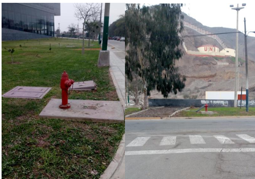
Figura 21. Hidrantes exteriores al Comedor UNI. Fuente: Propia
