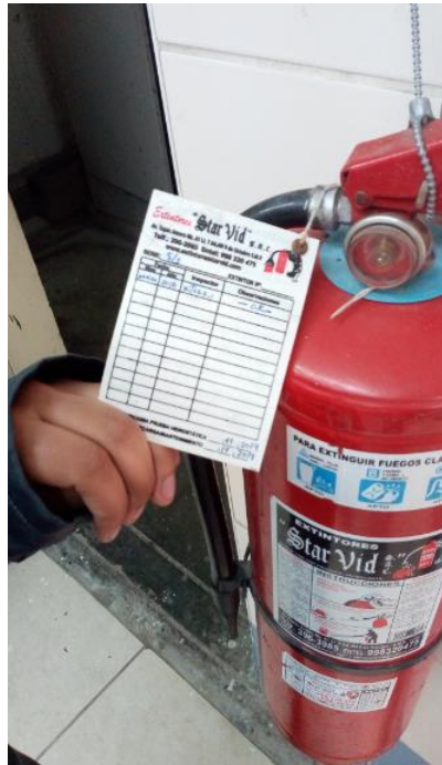
Figura 14. Tarjeta de extintor sin inspección. Fuente: Propia.
