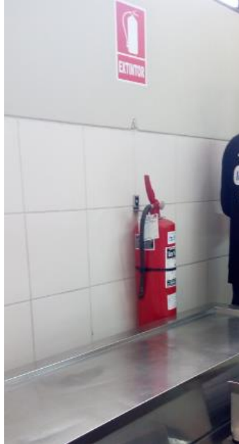
Figura 16. Extintor con acceso obstruido por la mesa de metal. Fuente: Propia.
