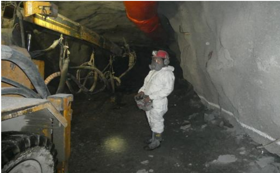
Figura 4.29: Operador de lanzamiento de shotcrete operando el control remoto del equipo Putzmeister.
