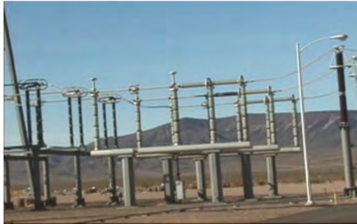
Figura Nº 3.22: Maniobra de Seccionador
