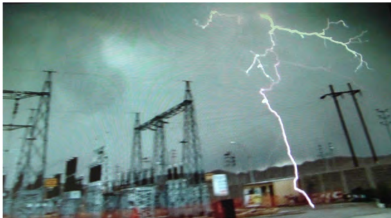
Figura Nº 3.21: Impacto de Rayo en Cable de Guarda y en Patio de Subestación
