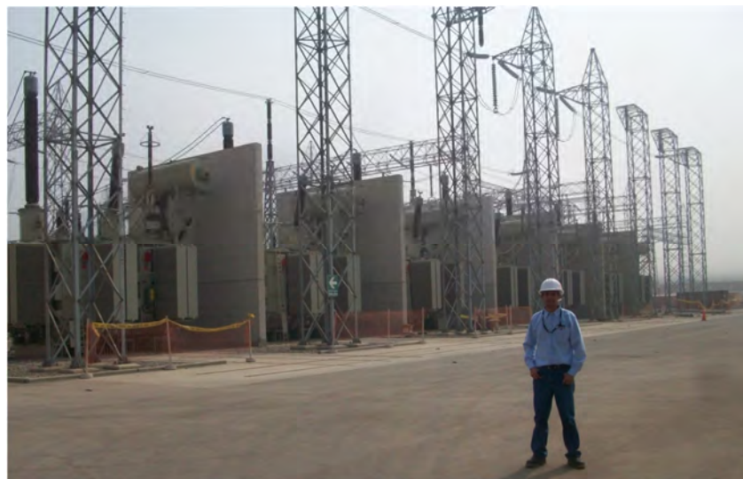
Banco de Autotransformadores – Subestación Carabaylo
