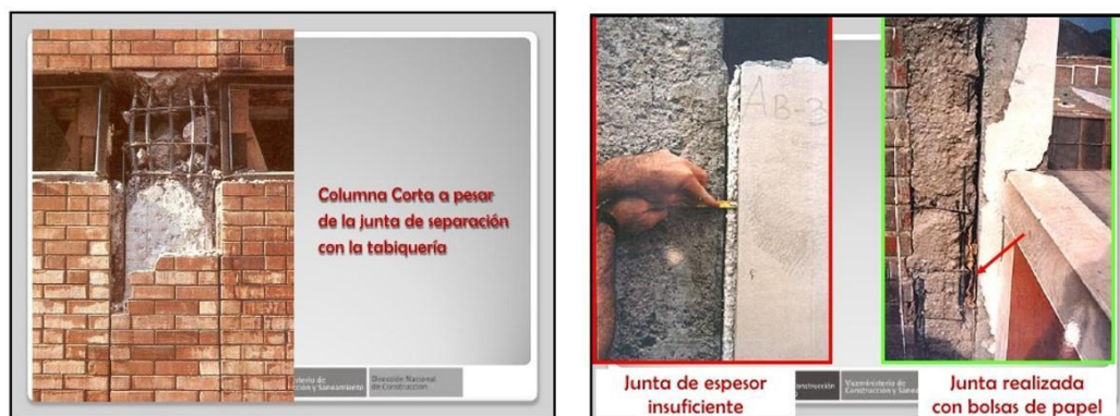
IMAGEN E24. Fallas por columna corta y junta sísmica insuficiente
