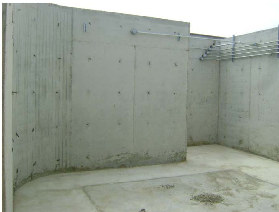
Figura 4.2. Interior de la instalación donde se ubicará el compresor.
