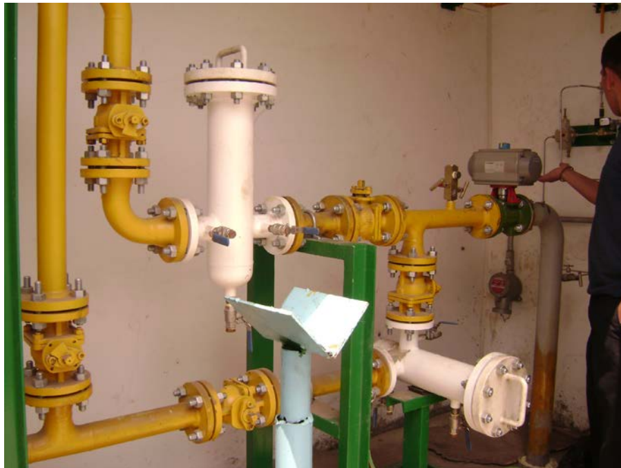
Figura 4.16. Puente de medición de la estación.
