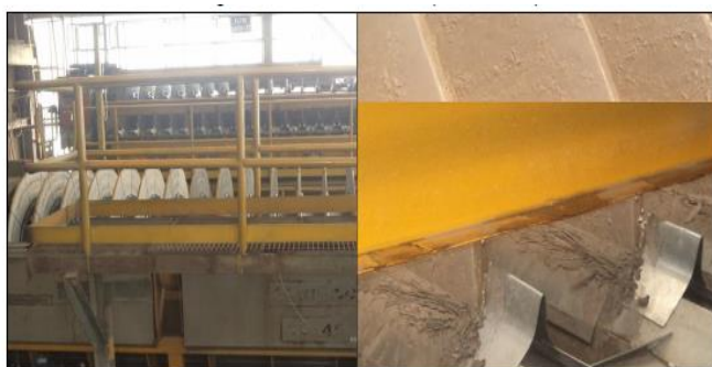
Figura 4.3: Sistema de filtrado (Filtros Larox) Fuente: Elaboración propia
