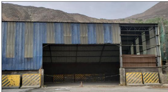
Figura 4.2: Almacén de la Planta de Filtrado Fuente: Elaboración propia
