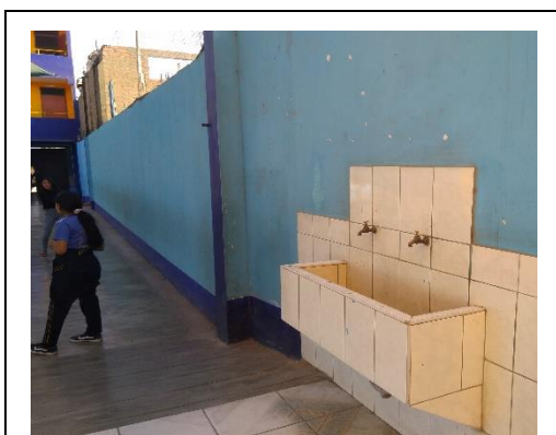
Fotografía 81: Grifo del lavatorio múltiple ubicado cerca al patio, que presentaba goteo.
