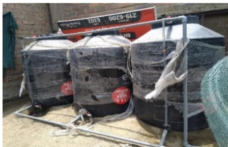
Fotografía 12: Tres (03) tanques de polietileno (1 100L) para el riego de áreas verdes.
