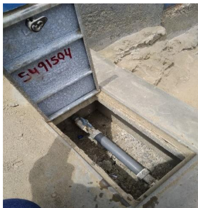
Fotografía 22: Ubicación de la caja de la conexión de agua, que no cuenta con medidor.
