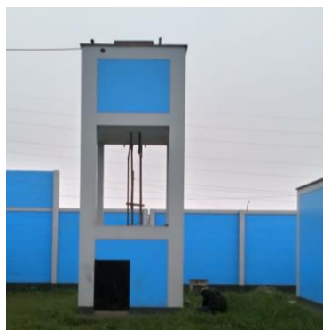
Fotografía 14: Sistema de abastecimiento indirecto de agua potable de la I.E.
