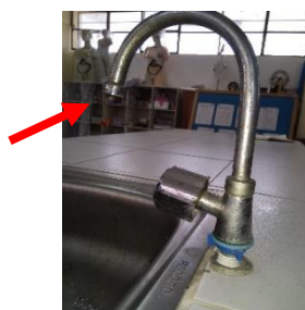
Fotografía 80: El lavadero del laboratorio de ciencias presentaba goteo.
