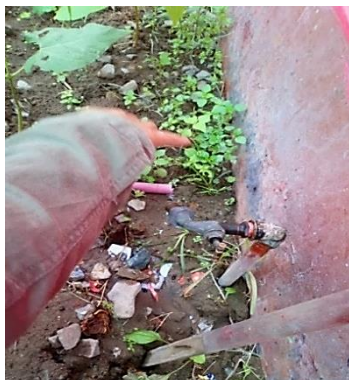
Fotografía 78: Grifo de riego que presentaba goteo.
