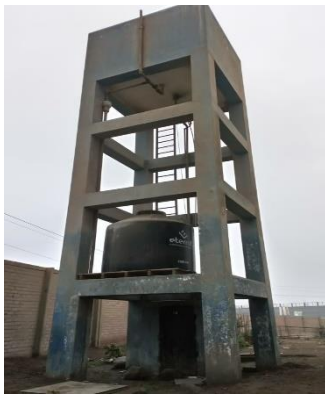
Fotografía 10: Sistema de abastecimiento indirecto de agua potable de la I.E.
