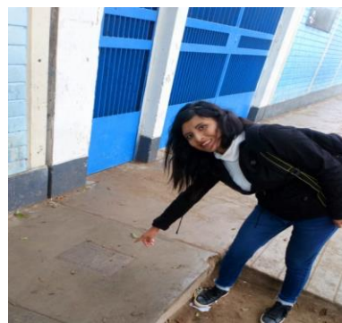
Fotografía 15: Localización de la caja del medidor de la I.E. administrado por SEDAPAL, sin acceso a su lectura.
