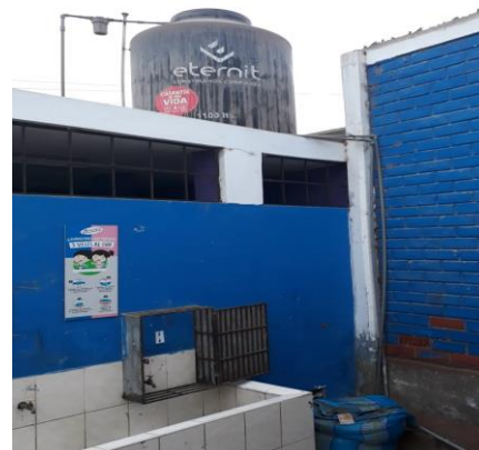
Fotografía 23: Tanque elevado de polietileno de 1100L que abastece de agua al servicio higiénico de mujeres.
