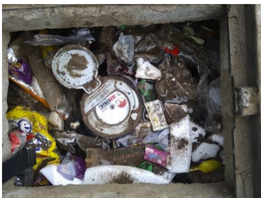
Fotografía 74: Caja de medidor de agua, lleno de residuos sólidos y agua.
