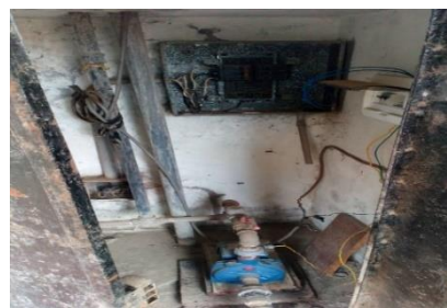
Fotografía 13: Vista del Sistema de Bombeo que se encarga de impulsar el agua al Tanque Elevado.
