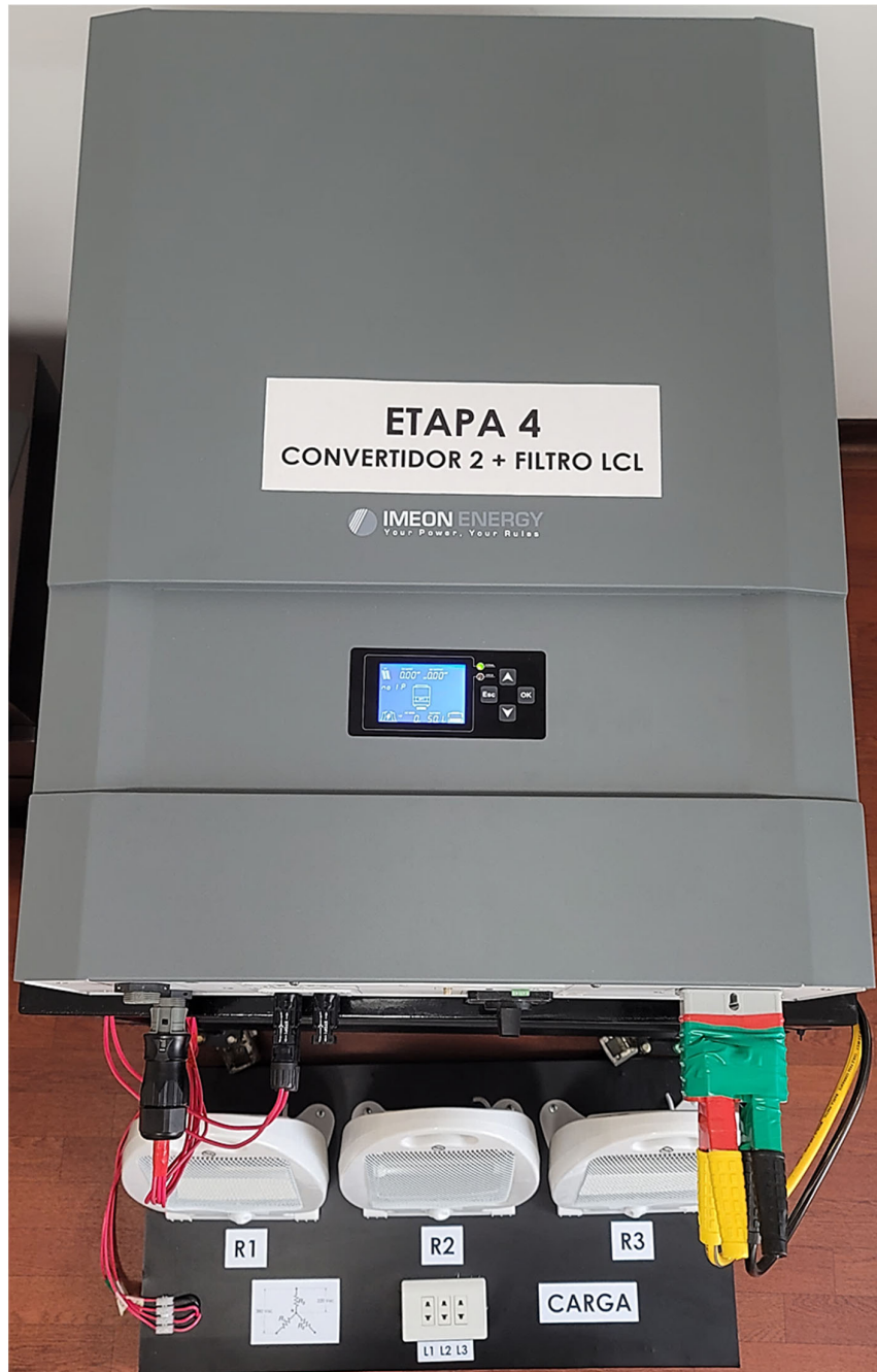
Figura 3.42 Convertidor 2 implementado en el prototipo del sistema convertidor de energía: Inversor solar híbrido IMEON 9.12
