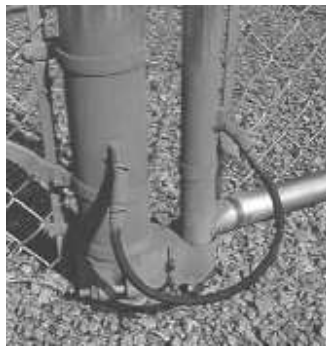
Figura 3.2 Ejemplo fotográfico de la equipotencialización del cerco. FUENTE: Motorola R56
