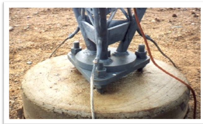
Figura 3.5 La estructura o torre a tierra
