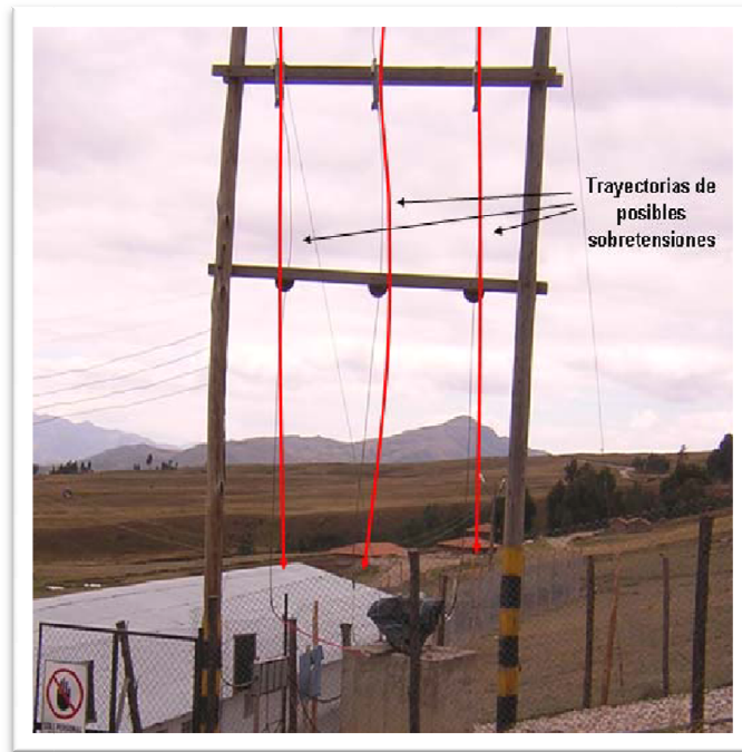
Figura 3.17 Ejemplo de Mala implementación de los electos en una subestación
