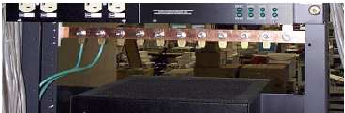
Figura 3.25 Barraje horizontal en el interior de un rack
