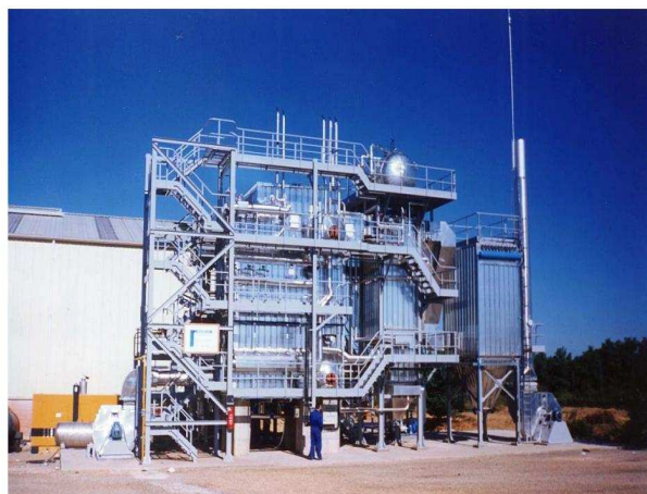
Figura 4: Planta de incineración con sistema CCLF en España
