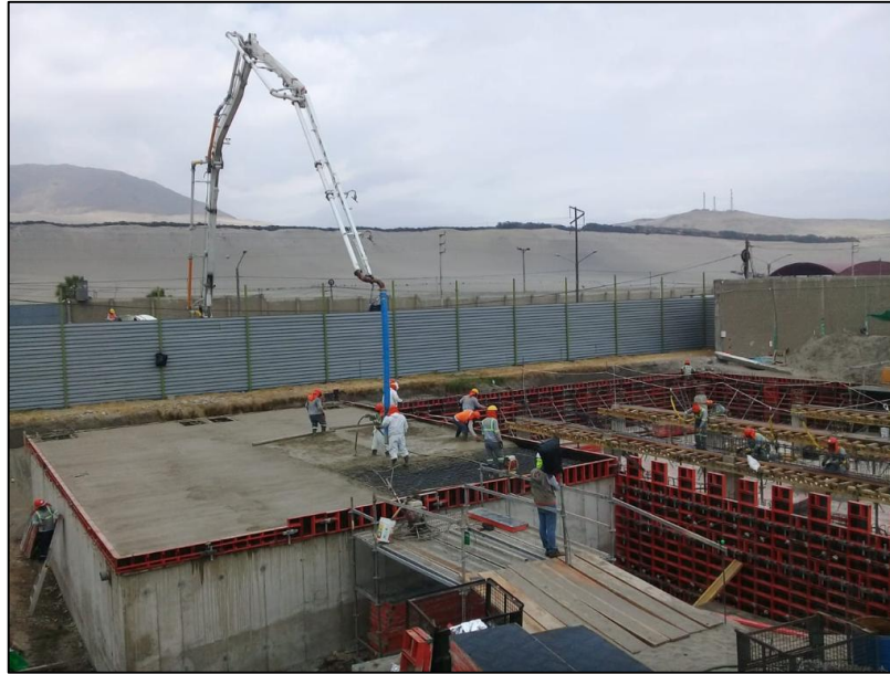
Figura 4.1.25. Vaciado de concreto en losa de techo de tanque equalizador. Fuente: Elaboración propia.
