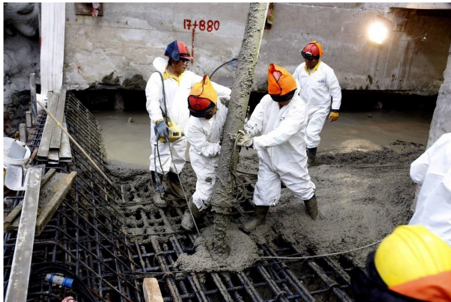
Figura 3.6. Colocación de concreto premezclado sobre una armadura de acero para posteriormente formar una estructura de concreto armado.
