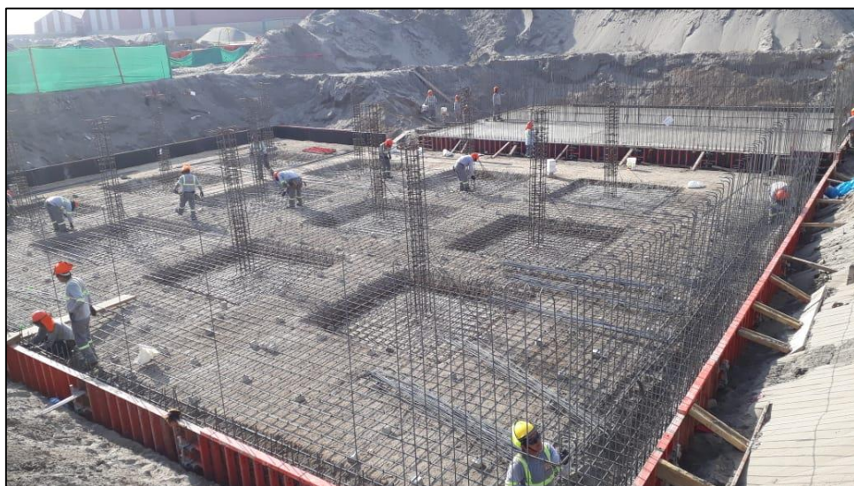
Figura 4.1.10. Encofrado de bordes de cimentación en cisterna de agua tratada, al fondo tanque equalizador. Fuente: Elaboración propia.
