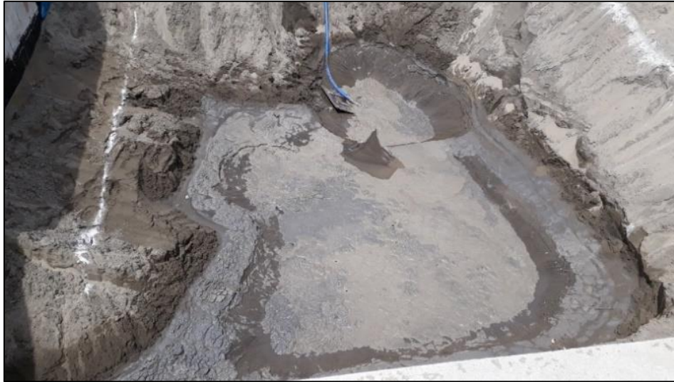
Figura 4.2.2.3. Depresión del nivel freático, posterior al bombeo de aguas. Fuente: Elaboración propia
