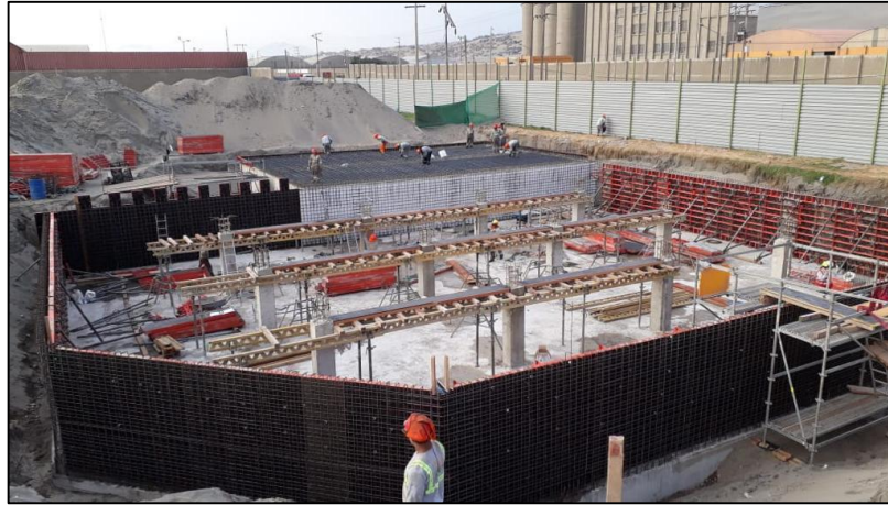
Figura 4.1.17.6. Proceso de encofrado de muros en cisterna de agua tratada. Fuente: Elaboración propia.
