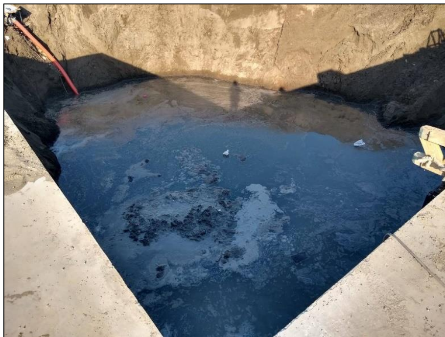
Figura 4.2.2.2. Nivel freático alto que dificulta la cimentación de las cámaras de bombeo. Fuente: Elaboración propia
