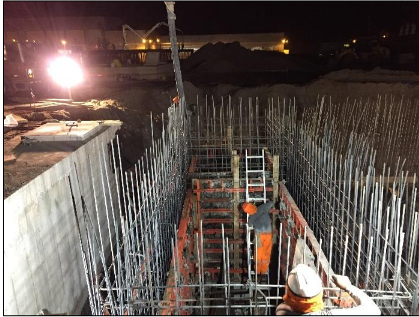
Figura 4.2.12. Vaciado de concreto premezclado en muros de las cámaras de bombeo. Fuente: Elaboración propia.
