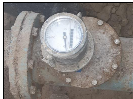
d. Medidor de caudal
