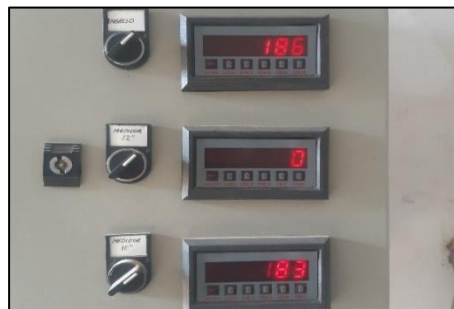
b. Registro de macromedidores
