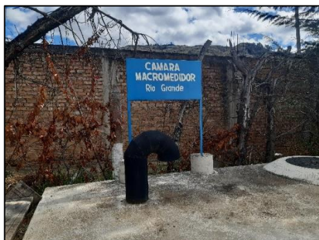
a. Cámara de macromedidor
