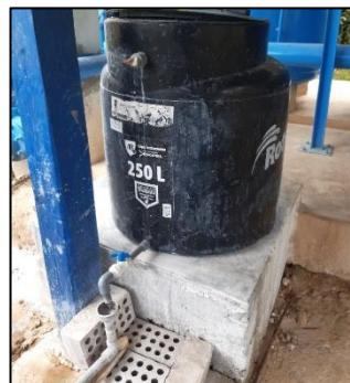
f. Tanque de cloración por goteo
