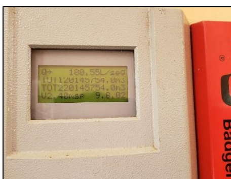
d. Registro de macromedidor
