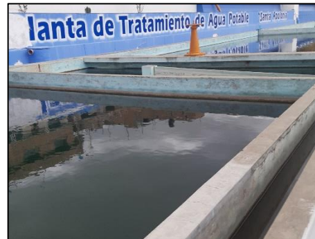
d. Vista de sedimentador
