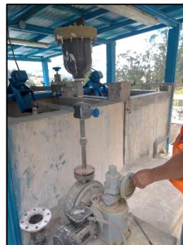
b. Dosificador inoperativo
