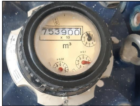
e. Macromedidor en I. aducción
