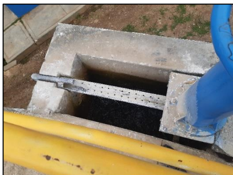
a. Tubo dosificador de cal
