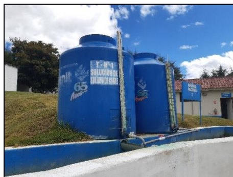
b. Tanques de dosificación (CuSO 4 )
