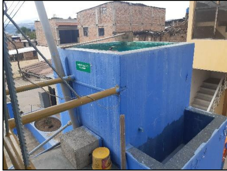
a. Tanque de sulfato de cobre
