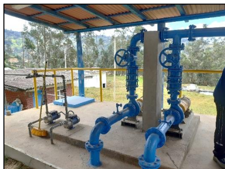
e. Sistema de cloración inoperativo
