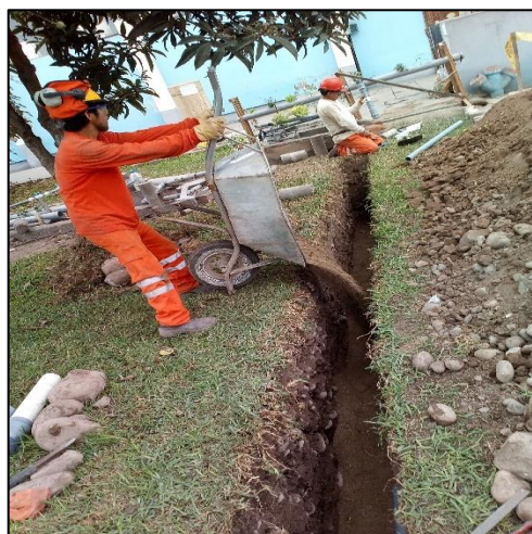
Figura 5.8: Relleno y compactación de zanja – red secundaria de Lab. Nacional de Hidráulica
