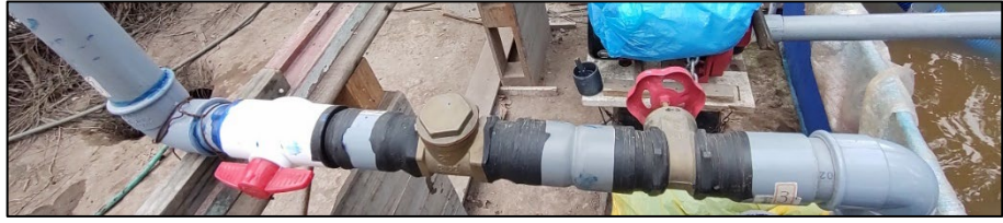
Figura 4.6 Válvulas de control
