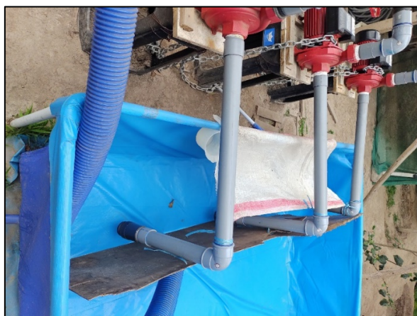
Figura 4.4 Vista de las líneas de succión
