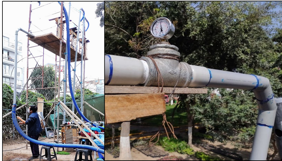
Figura 4.22 Bajante Principal del sistema sifónico
