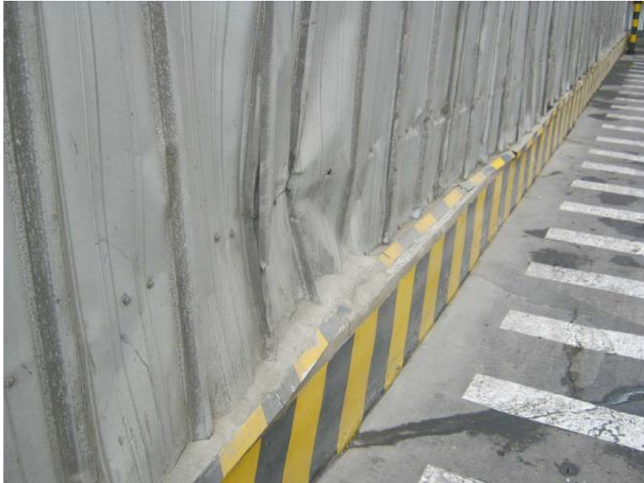
Figura 6.1-28 Abolladuras en cerramiento del almacén Fuente: propia
