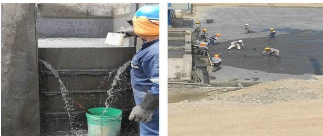
Figura 2.29. Cocha de almacenamiento de concentrado y secado de concentrado
