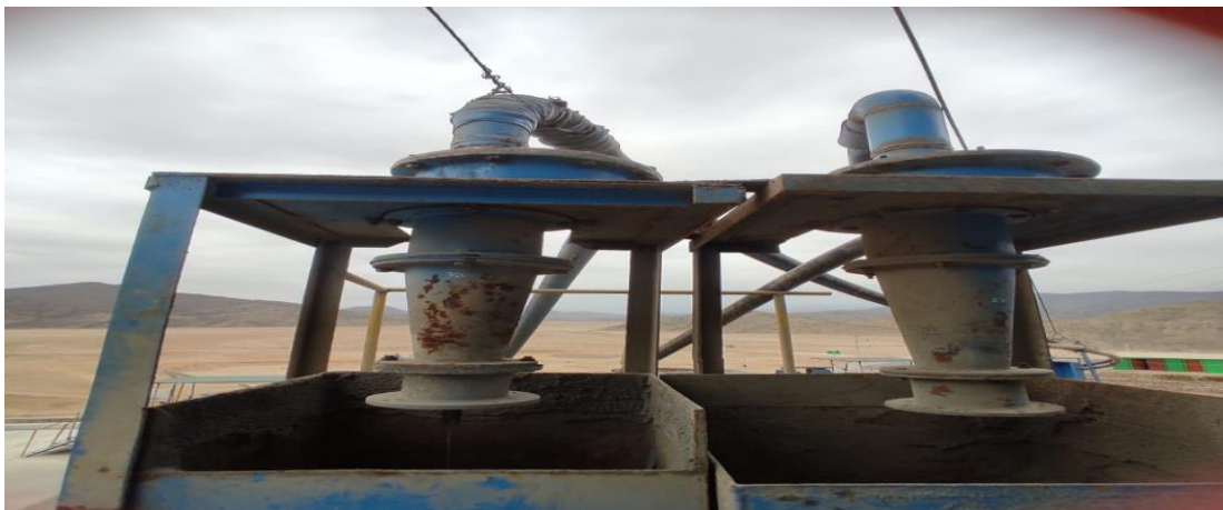
Figura 2.24. Hidrociclones D-7 de la Planta Concentradora Centenario
