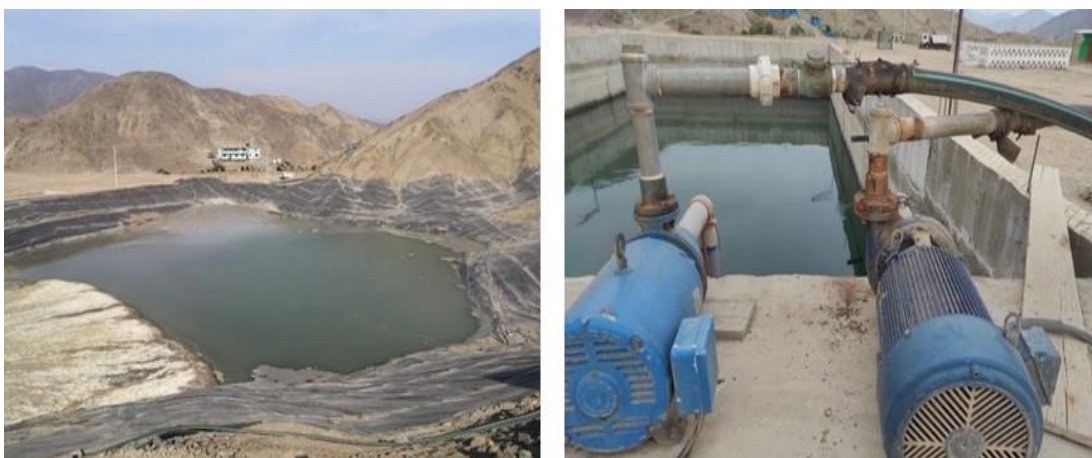
Figura 2.31. Depósito de relaves y poza de agua recirculada de la Planta Concentradora Centenario
