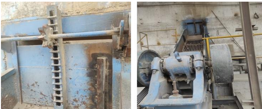
Figura 2.20. Compuerta de descarga de la tolva de gruesos y Chancadora Primaria de Quijada
