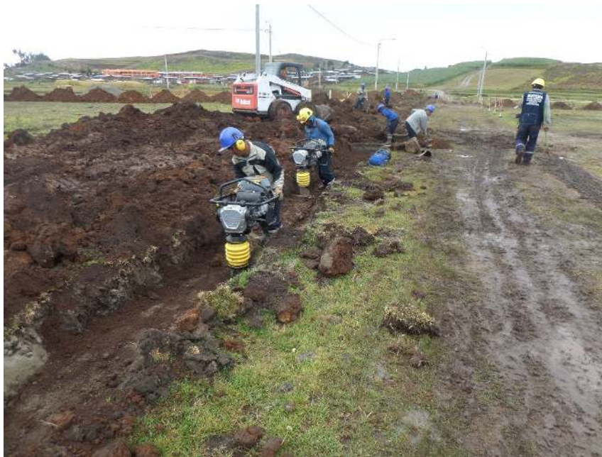
Instalación de redes de agua potable para el incremento de la cobertura de acceso a este servicio en el ámbito rural de la región Piura.
