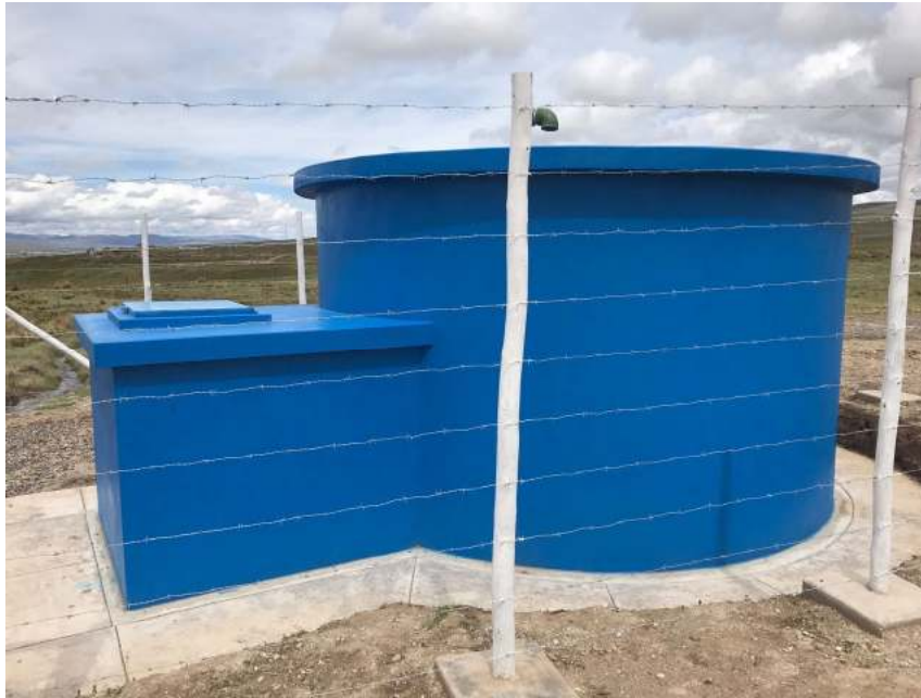
Sistema de almacenamiento de agua potable para el mejoramiento del servicio de continuidad y presión en las localidades rurales de la región Piura.
