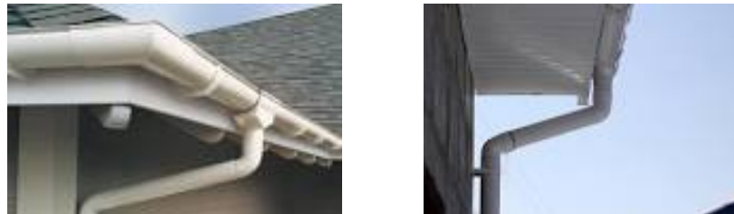
Figura N° 2.2: Canaletas de Recolección y Bajantes
