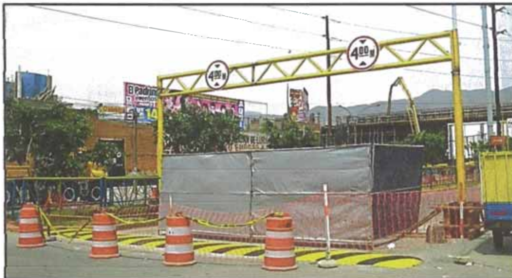
Figura N° 5.94: Pórtico de Señalización.
