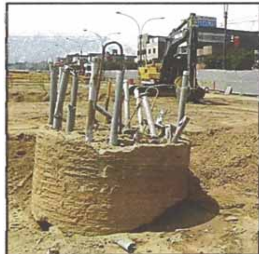
Figura N° 5.90: Ductos de PVC flotando sobre la cabezal de pilote
