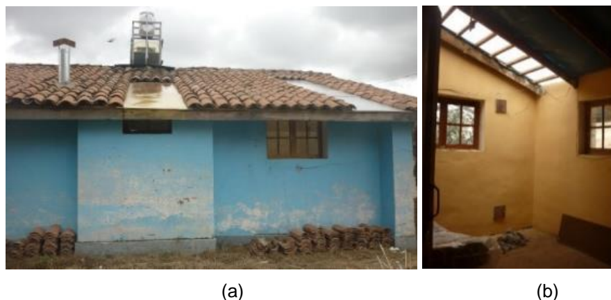
Figura 40. Albergue después de la instalación de la claraboya, año 2015: (a) la fachada sur y (b) el ambiente interior del dormitorio D2.
