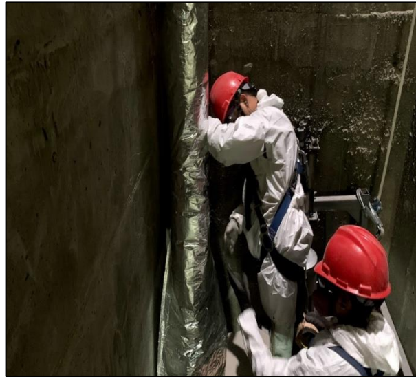
Forrado de las tuberías de la línea de gas con lana de vidrio
