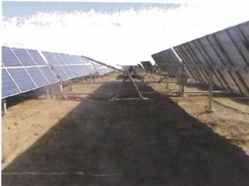
Figura 3.9 Vista del Seguidor Solar en la Central Panamericana Solar
