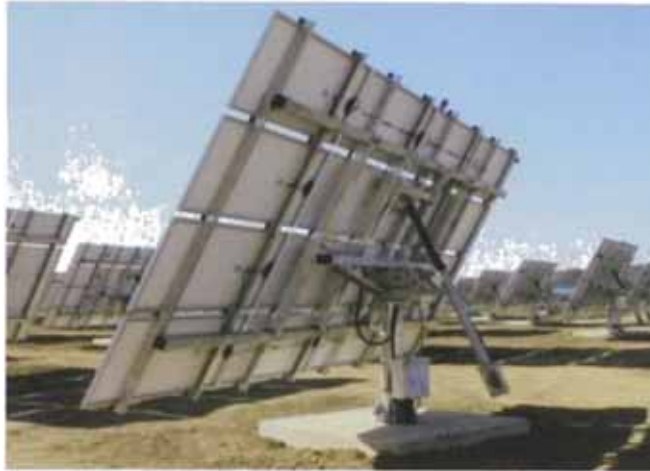
Figura 2.20 Seguidor Solar de Doble Eje
