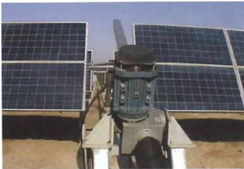
Figura 3.8 Vista del Seguidor Solar en la Central Tacna Solar
