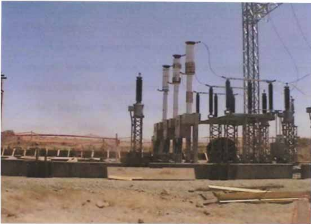
Figura 2.22 Subestación Eléctrica (S.E. - 23/138 kV) de la Central Panamericana Solar (Moquegua – Perú)
