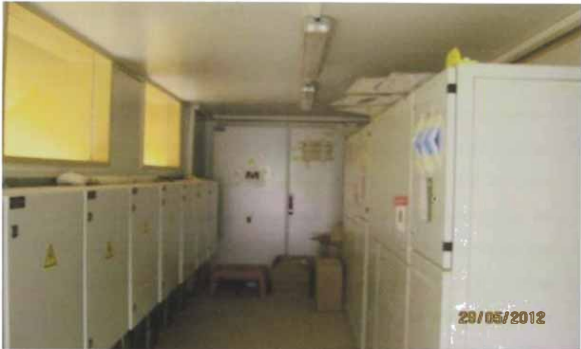
Figura 2.21 Centro de Transformación de la Central Majes Solar (Arequipa – Perú)
